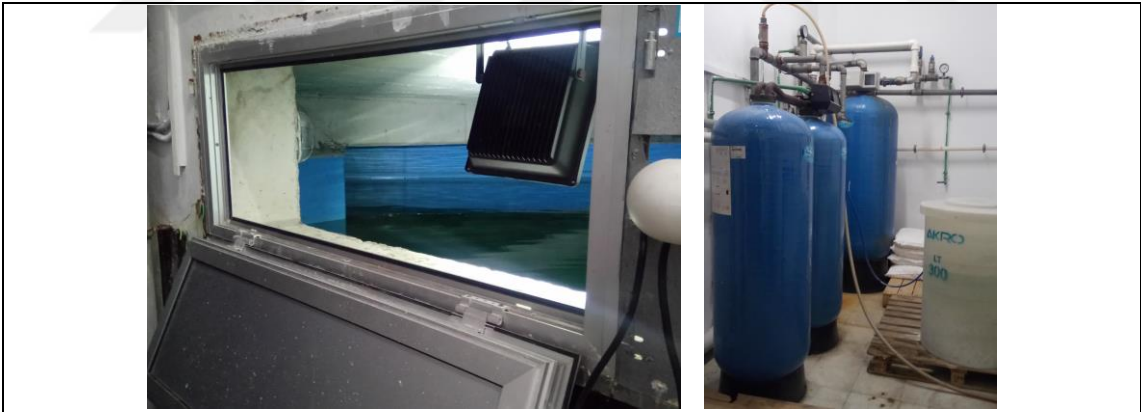
Resim 13. Betonarme Su Deposu ve Su Arıtma Sistemi (Seher Öz Arşivi, 2018)
