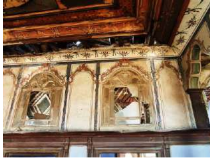
Resim 12 Revzen pencere etrafında görülen kalemîşi bezemeler
