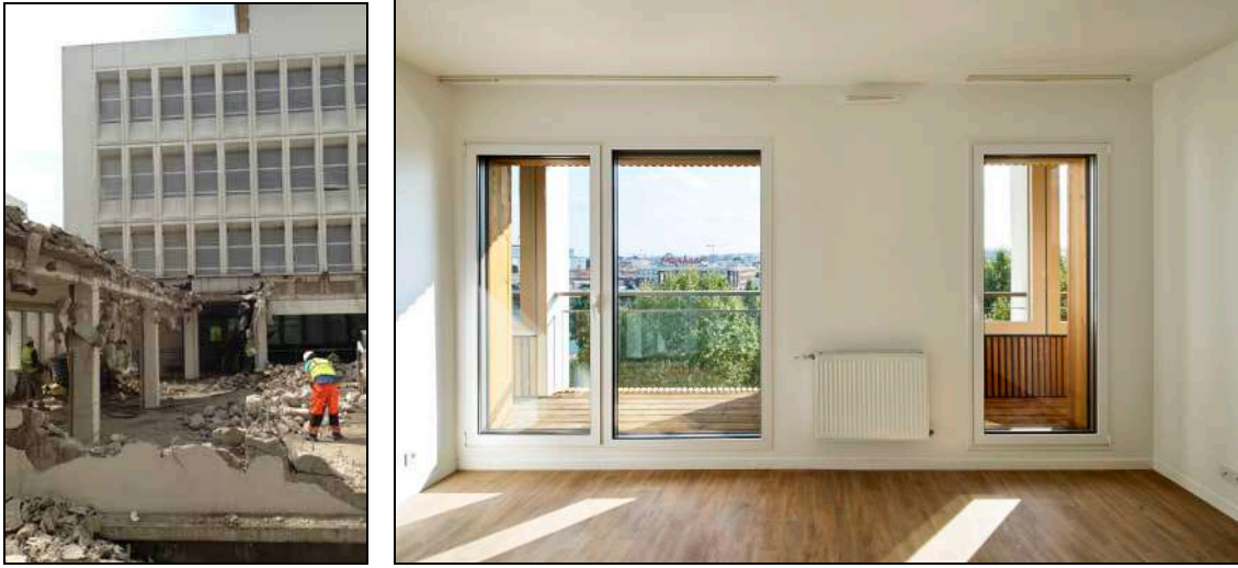
Şekil 3.8. 90 Housing And Office Yıkılan Bölüm (Anonim 2) (Solda)
