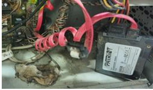
Şekil 3.143. Güç kablosunu ısırılmış bir fare örneği
