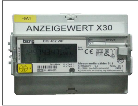
Şekil 15. Mikro kojenerasyonun elektrik ölçüm sayacı
