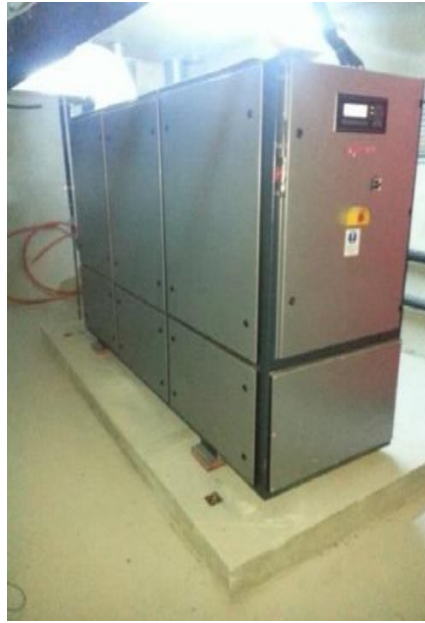
Şekil 18. Kurulumu gerçekleştirilen blok tipi mikro kojenerasyon
