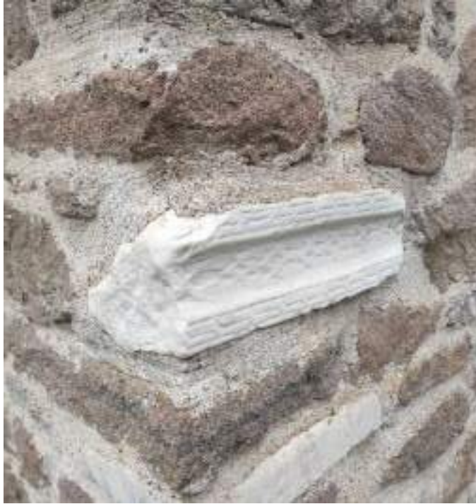
Fotoğraf 143: Evhadü'd-Din Hamid Bin Ebulfahır Kirmanî Türbesi Köşe Kenarı Devşirme Malzeme
