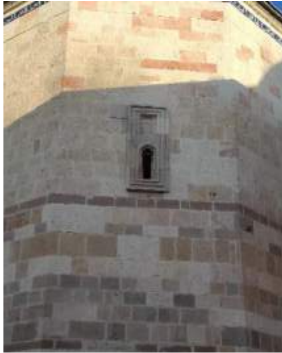
Fotoğraf 8: II. Kılıçarslan K mbeti Yedinci Duvar Y zeyinde Bulunan Mazgal Pencere
