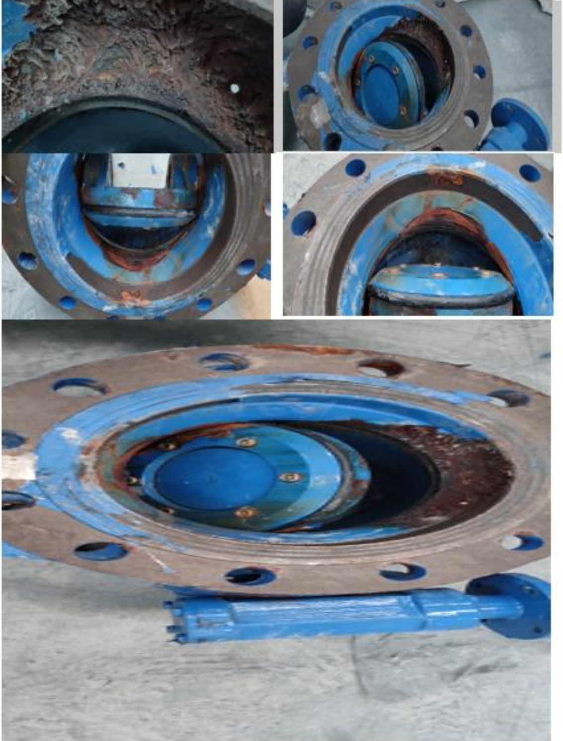
Şekil 16. Vanalarda oluşan kavitasyon olayı (Karabük, 2022)
