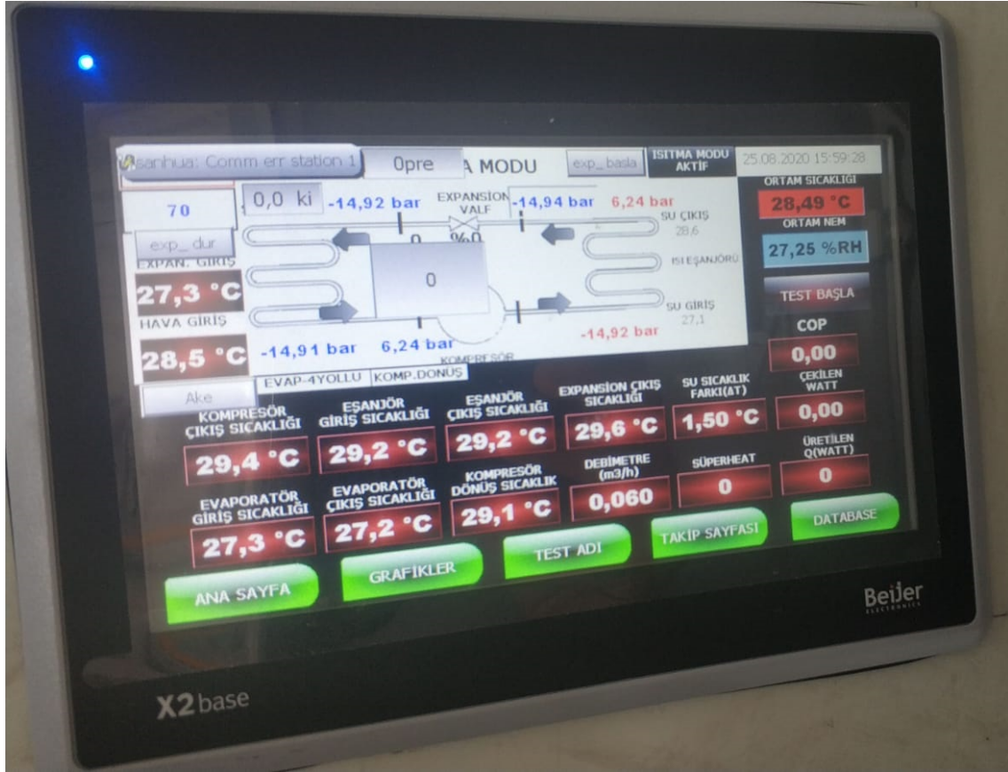
Şekil 3.13. Klimatik test odası kontrol ünitesi üzerinde yer alan PLC ekran
