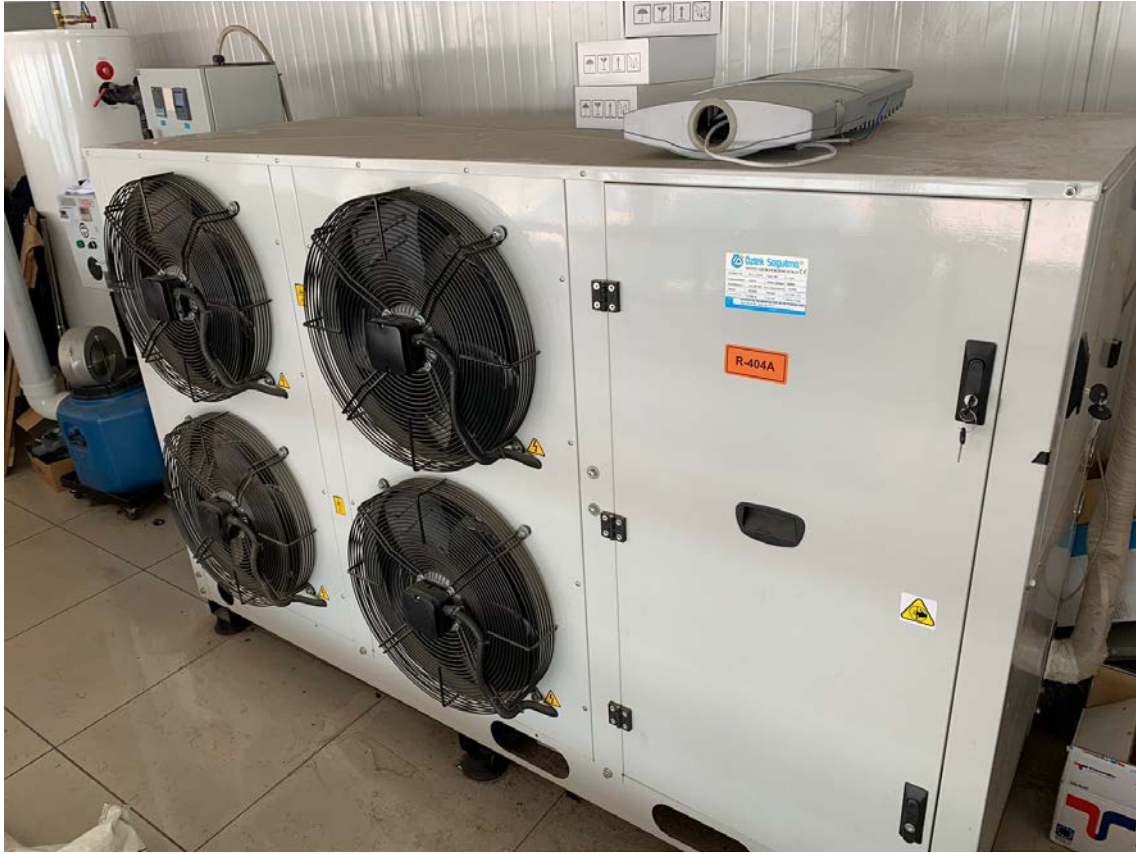
Şekil 3.9. Klimatik test odasını soğutmak için kullanılan dış ünite
