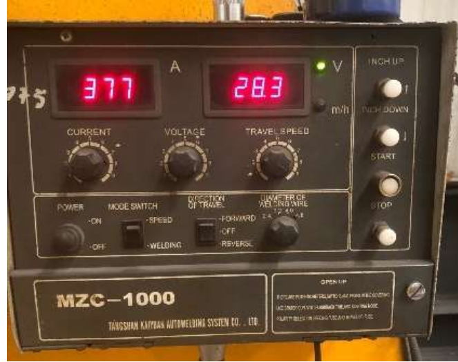
Şekil 7.3. Kamesh Welding tozaltı kaynak robotu kontrol paneli
