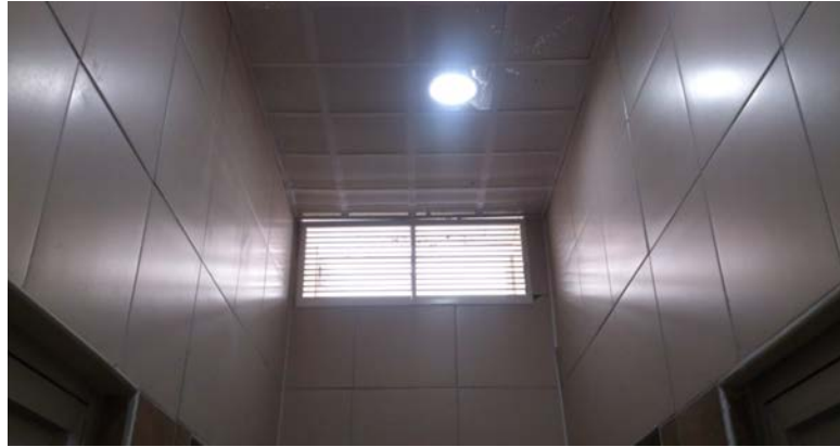
Şekil 5.3. Selçuklu Hizmet Binasının tuvalet havalandırmalarında açık bırakılan menfez (27.01.2018)
