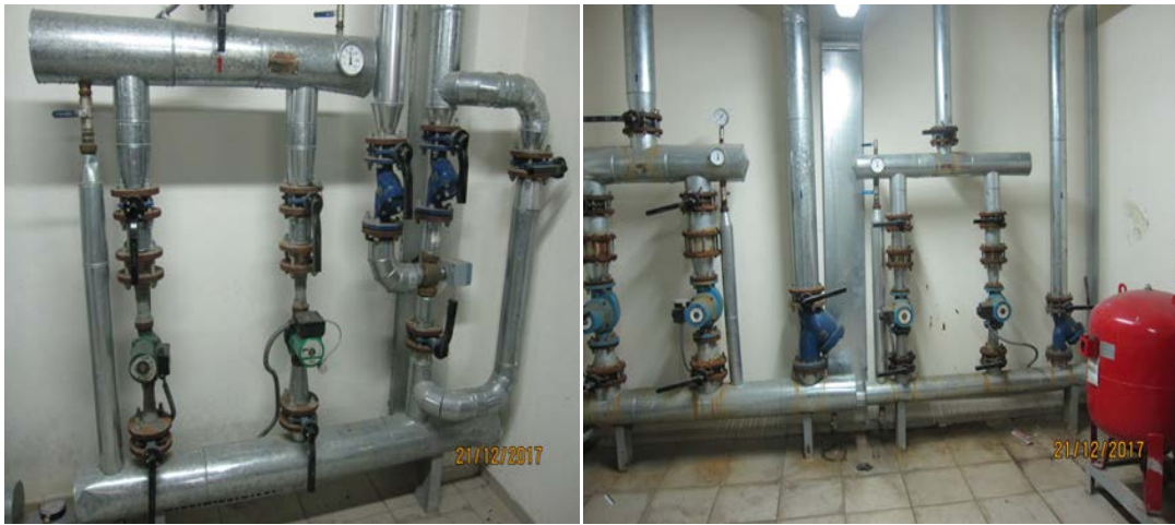
řekil 5.5. Isıtma tesisatında yalıtımın olduđu vanalarda ise yalıtımın olmadıđını gsteren resim
