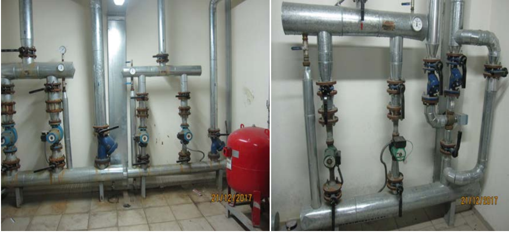
Şekil 5.11. Binanın Kalorifer Dairesindeki A-B-C-D Bloklarına Su Basan Sirkülasyon Pompaları
