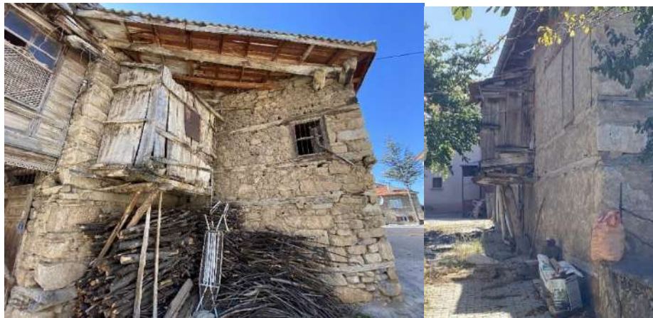
Fotoğraf 3.34. Beyşehir Üstünler kasabesindeki tarihi konut yapılarının cephelerinden çıkıntı yapan helalar (Dişli, 2022)
