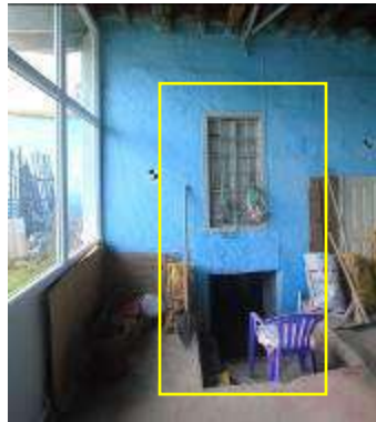
Fotoğraf 4.31. 137 ada, 34 parsel tescilli evin bodrum kat Oda-B-01 kapısı ve ZK-04 mutfak penceresi (Yazarın arşivinden, 2018)
