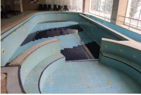
Resim 4.35: Hidroterapi havuzu iç görünümü
