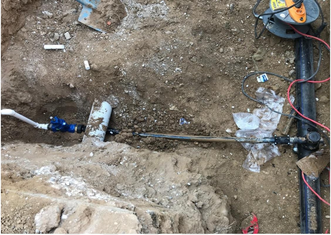
Şekil 7.2. Zarar görmüş PE abone şube yolu yenilenmesi ve servis vanası değiştirilmesi (KOSKİ, 2022)
