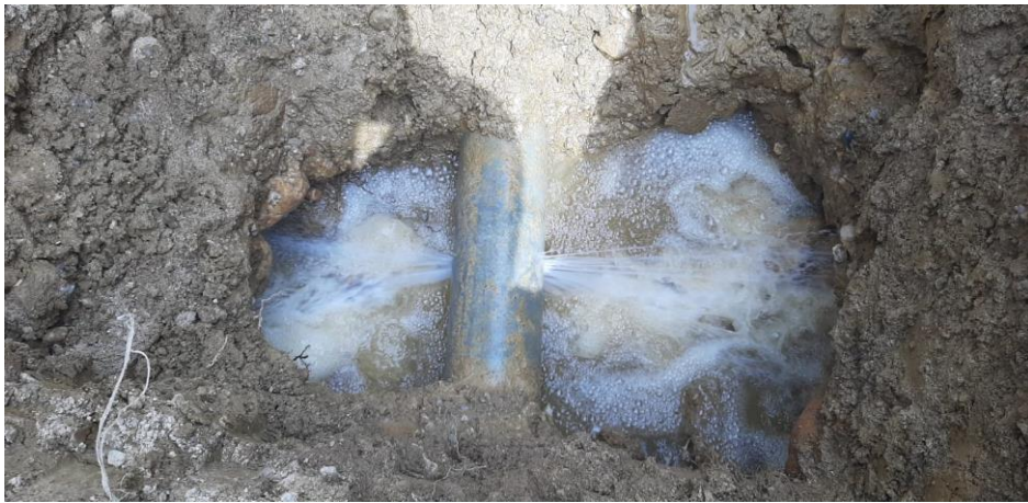
Şekil 4.1. Asbest Boru Arızası (KOSKİ, 2021)
