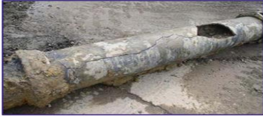
Şekil 4. 18. Su koçu darbesiyle kırılmış boru (Muhammetoğlu ve Muhammetoğlu, 2017)
