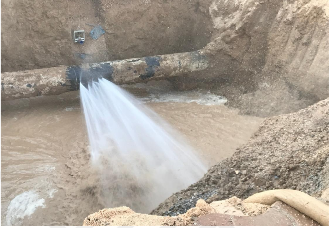
Şekil 7.4. Çelik borunun eski olmasından kaynaklı su kaçırmaları (KOSKİ, 2022)
