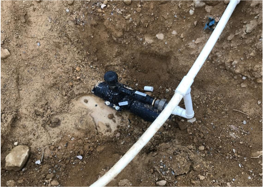
Şekil 7.3. Zarar görmüş PPRC boru değiştirilip bakım-onarım işlemi tamamlanmıştır (KOSKİ, 2022)
