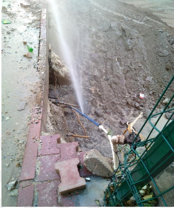
Şekil 7.6. Kazı yapılırken abone hattına zarar verilmesi sonucu su kaybı (KOSKİ, 2022)
