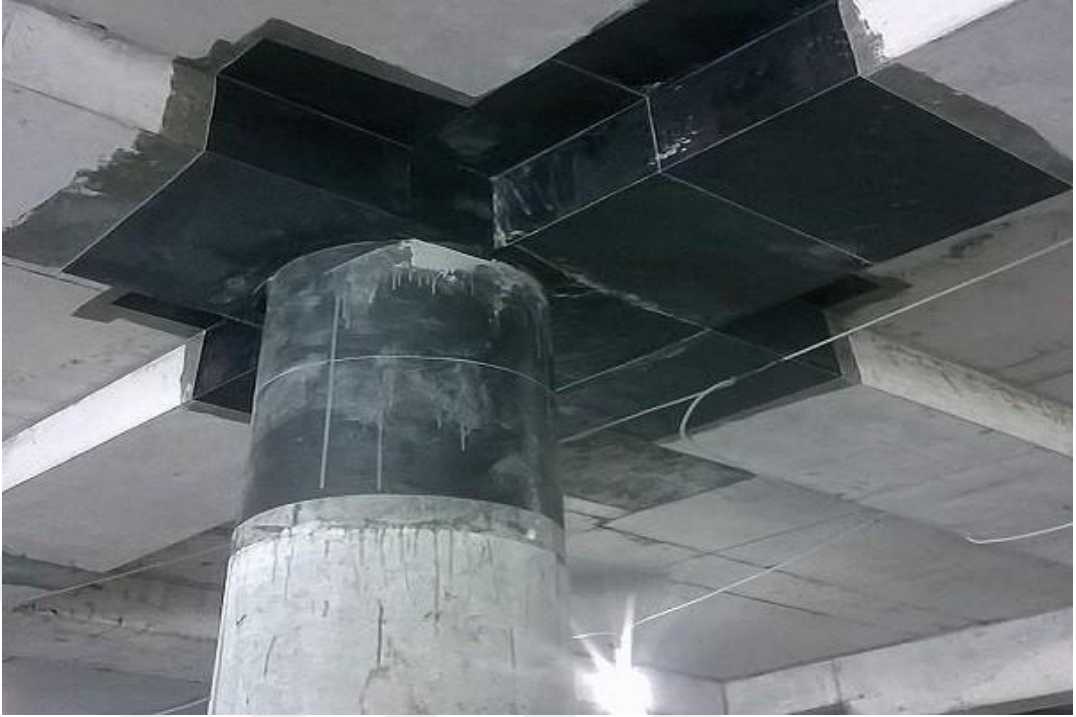
Şekil 1.2. Betonarme yapı elemanı kiriş ve kolonun FRP malzeme ile güçlendirilmesi (Anonim 2018b)
