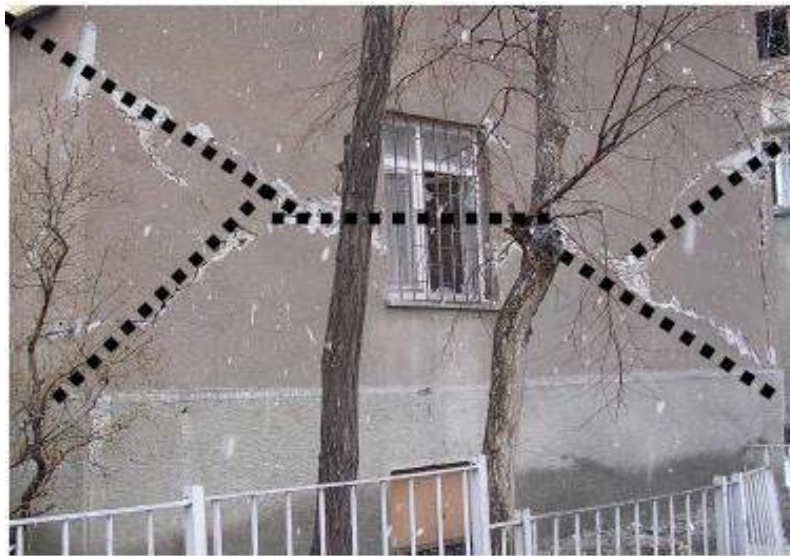
Şekil 3.15: Yığma yapı duvarında oluşmuş basamaklı çatlak .(Korkmaz, 2007)
