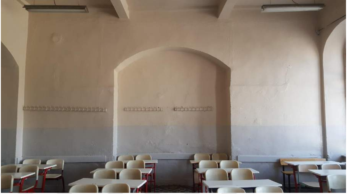
Şekil 4.1.1 : Sonradan İlave Edilen Briket Duvar Örneği.
