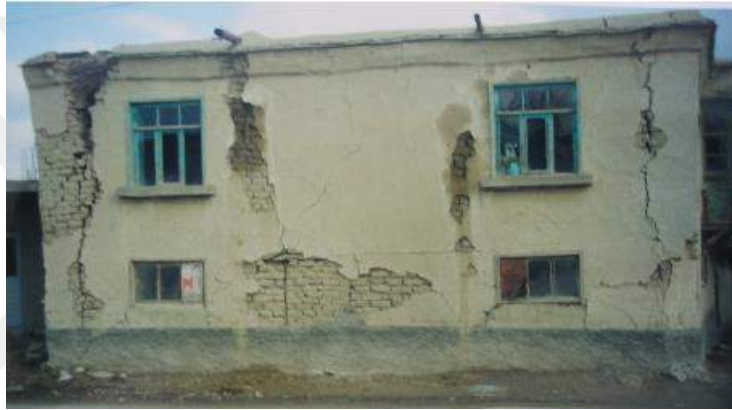
Şekil 3.16: (Akşehir-2002 Sultandağı depremi) Duvar birleşimine yakın oluşmuş düşey çatlaklar. (Korkmaz, 2007)
