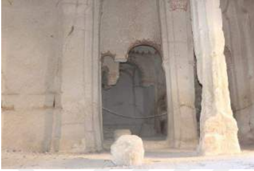
Fotoğraf 446: St.Paul Kilisesi Güney Cephesi
