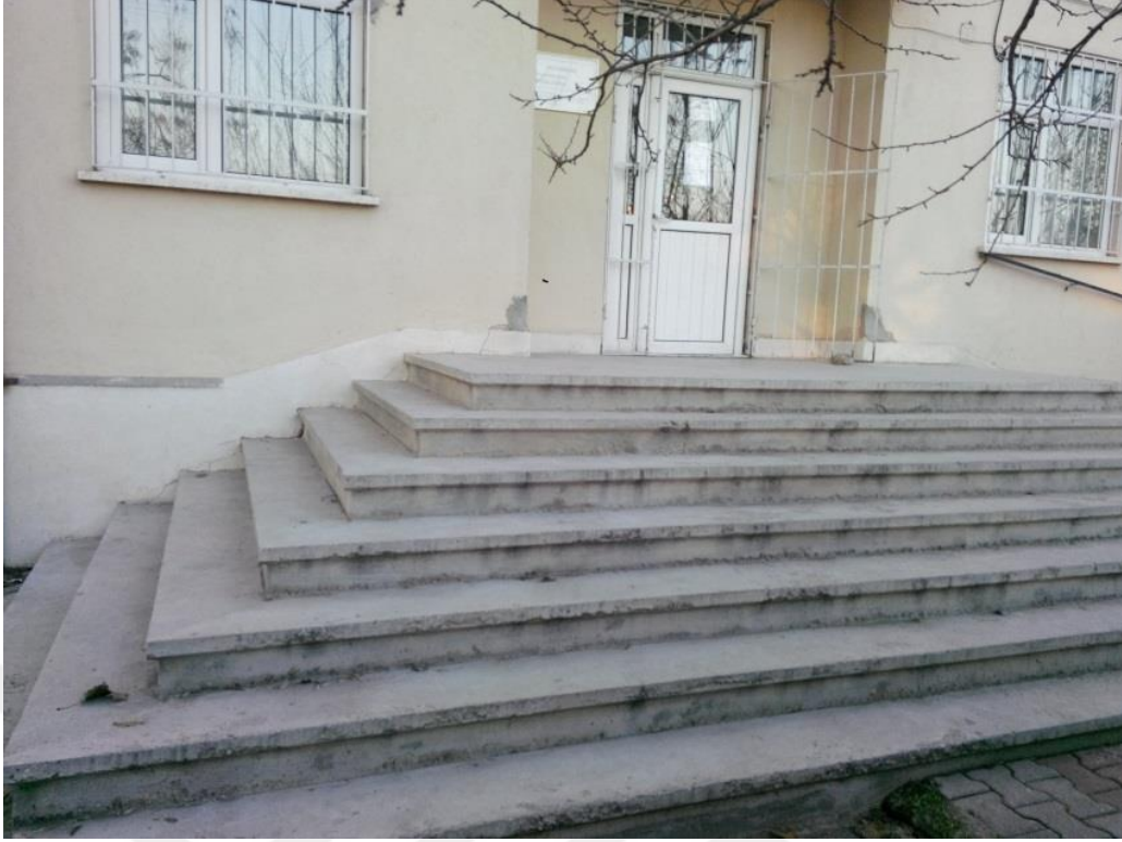
Şekil 1.1 Örnek Bir Sağlık Ocağına Girişine Ait Engelli Ulaşımına Uygunsuz Merdiven
