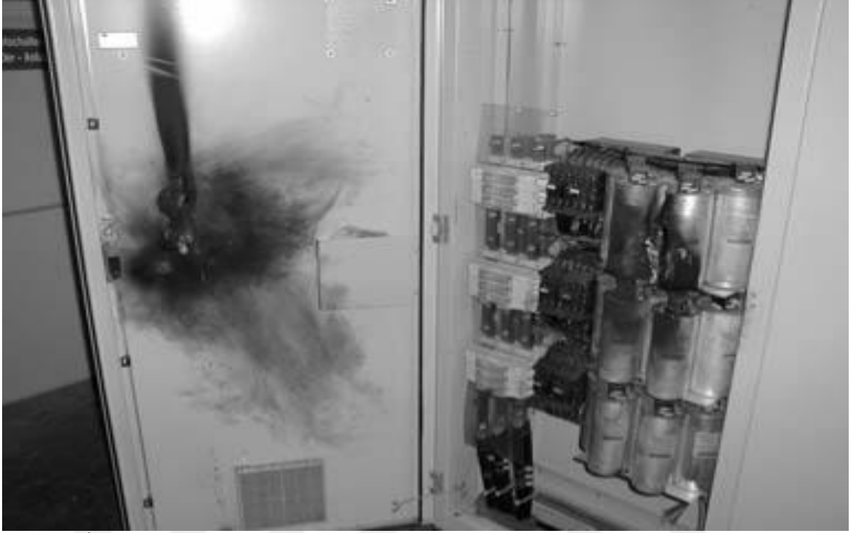
Şekil 4.2. İyi kontrol edilmeyen bir sistemde oluşan rezonans sonucu kapasitif elemanların tahribatı. [26]
