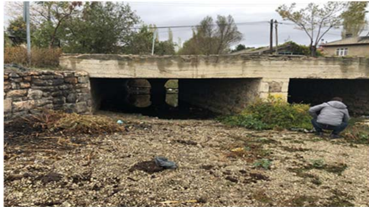
Şekil 1-4. Konya Akçalar Mahallesi Taşkın Koruma Tesisinde Rüsubat Birikimi (Cengiz, 2020)
