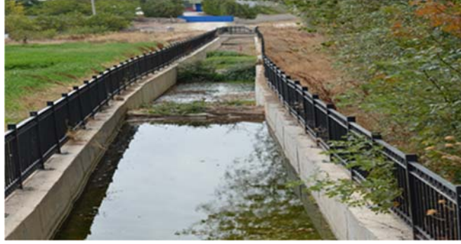
Şekil 1-5. Konya Kulu Canımana Mahallesi Taşkın Koruma Tesisi (Cengiz, 2020)
