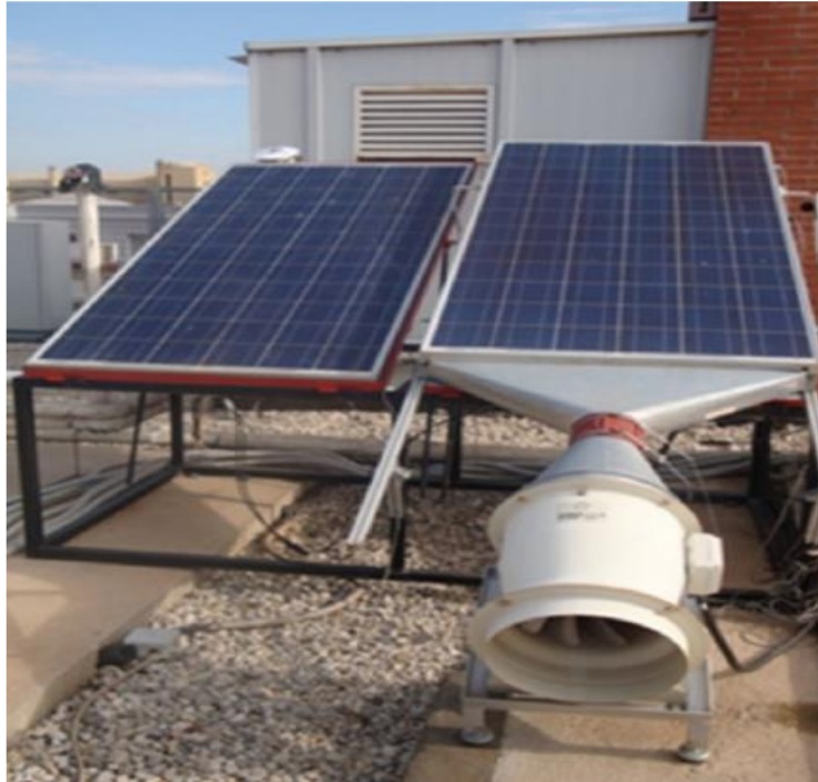
Şekil 1.2. Fan ile yapılan zorlanmış hava soğutma yöntemi (Kaynak: Hernandes, 2013)
