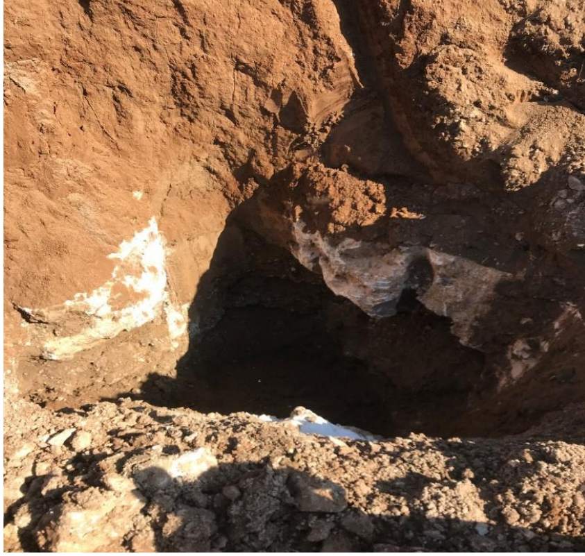
Şekil 4.20. Toprak kanalda oluşan obruklar
