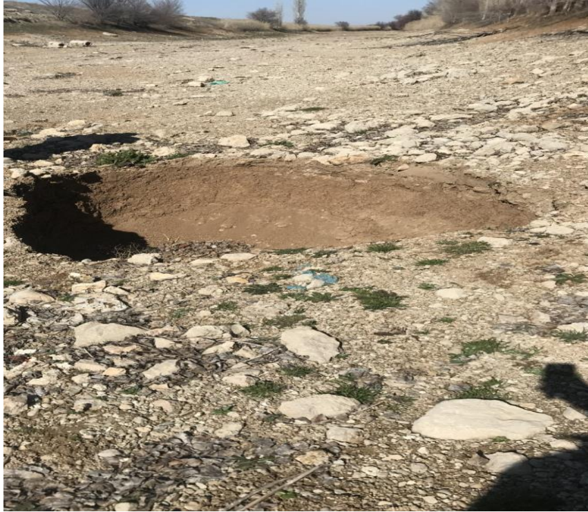
Şekil 4.21. Toprak kanalda oluşan obruklar
