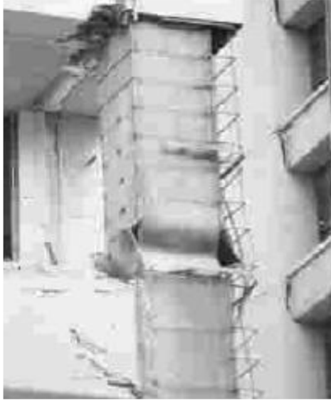
Şekil 3.19. Mexicocity’de yüksek katlı Pino Suarez binasında kutu kolonlarda oluşan lokal burulma
