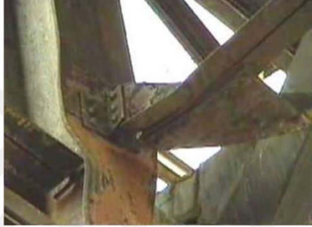
Şekil 3.23. Adapazarı vagon fabrikasında meydana gelen deprem hasarı (Kaltakçı ve ark., 2007)
