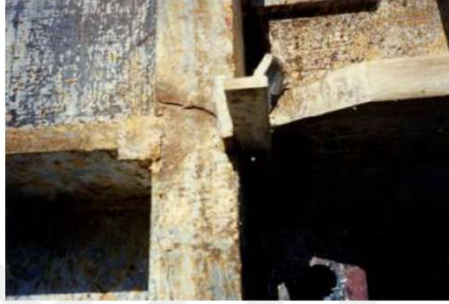
Şekil 3.20. Peter J. Maranian tarafından çekilen Northridge depreminden sonra 2 katlı çelik bir yapıda oluşan hasar (D 1 Sarno ve Elnashai, 2002)
