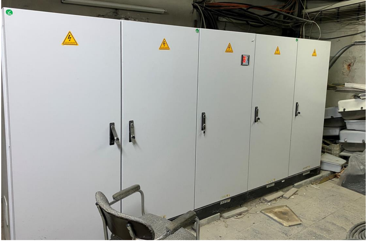
Şekil 5.53. Enstitü binası ana dağıtım panosu odası
