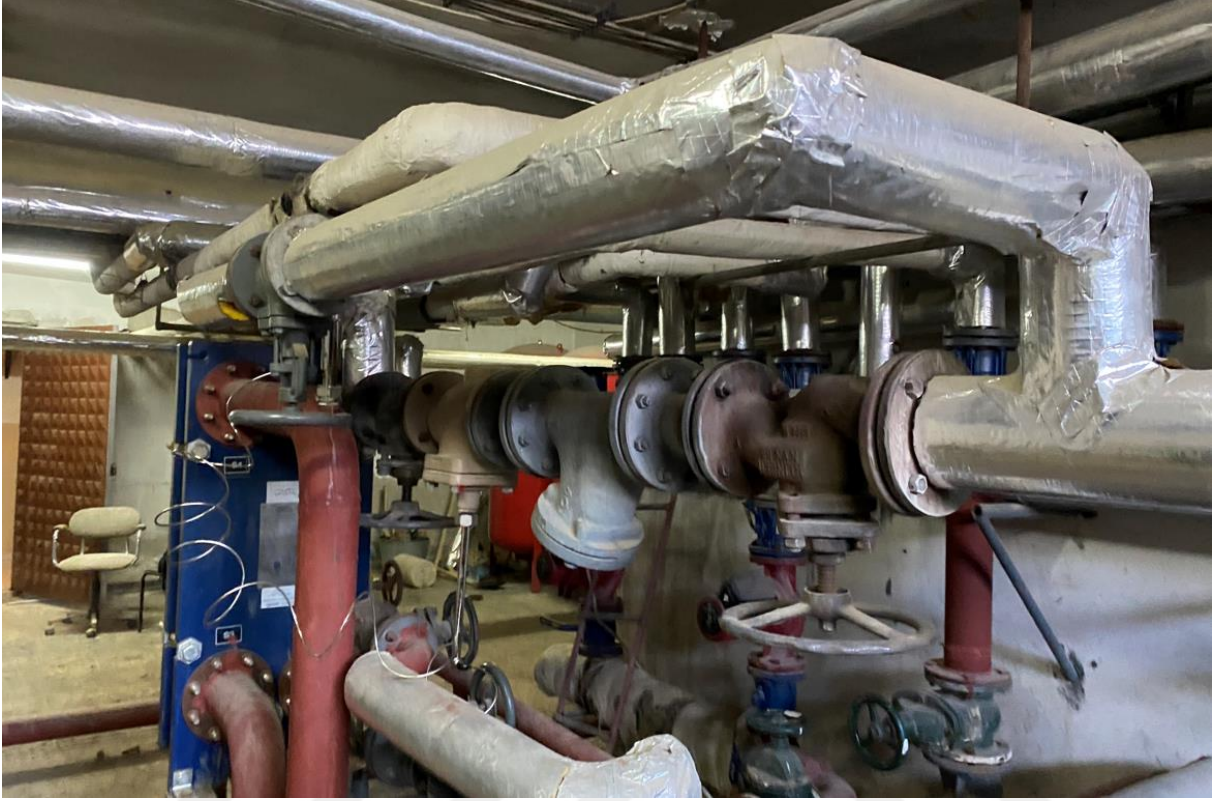
Şekil 5.47. Enstitü binası mekanik tesisat sistemi genel görünüm (eşanjör dairesi)
