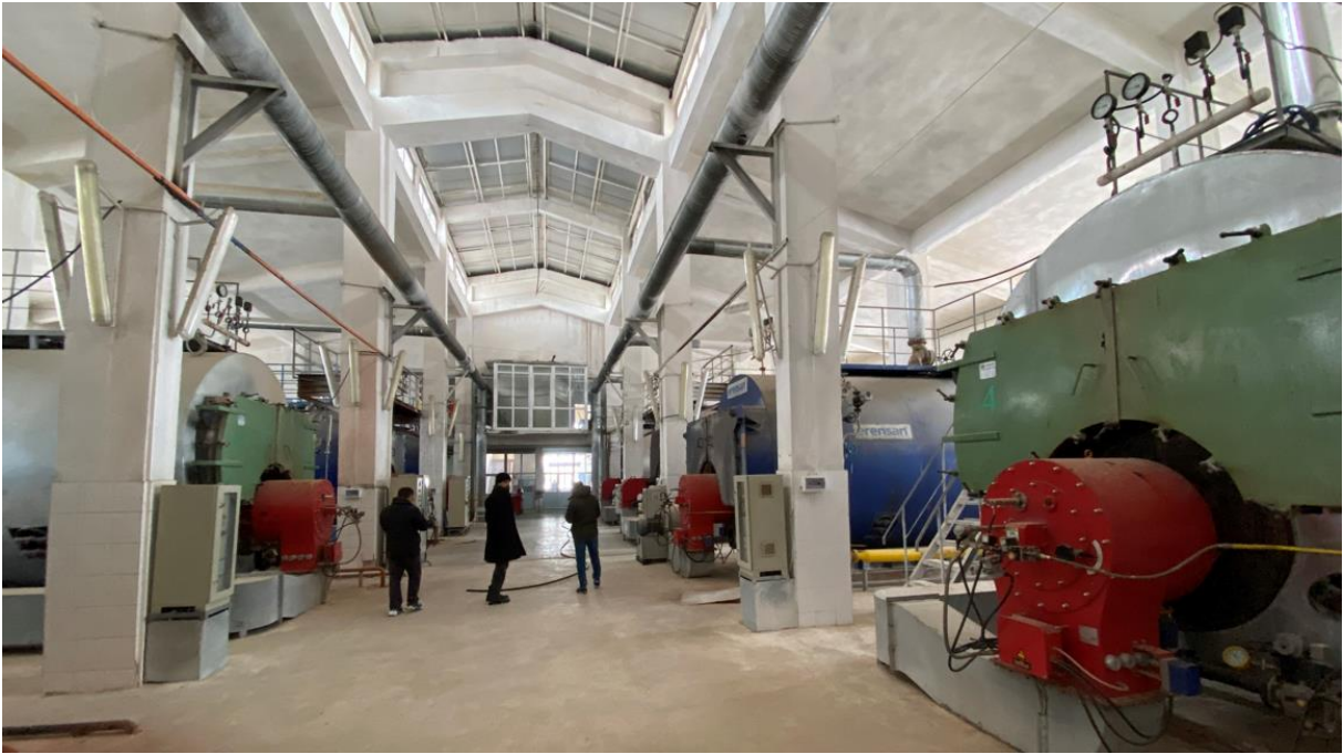
Şekil 5.32. S.Ü. Isı merkezi kazanlar genel görünüm
