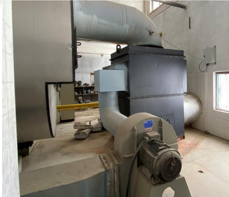
Şekil 5.34. Yanma havası ön ısıtma sistemi görüntüleri
