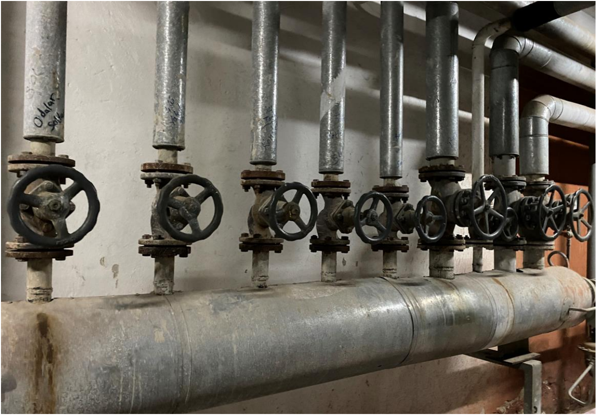
Şekil 5.46. Isı merkezi mekanik tesisat sistemi genel görünüm
