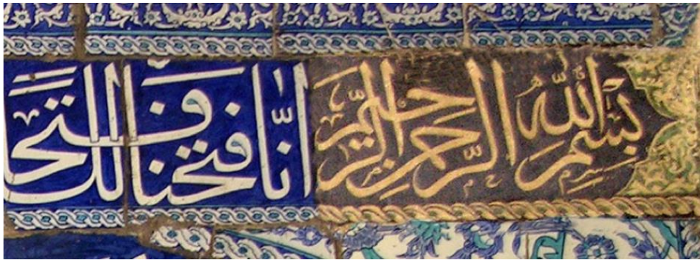
Resim 71. Kuşak Yazısı Restorasyon Öncesi Besmele Kısmı (Çelebi)
