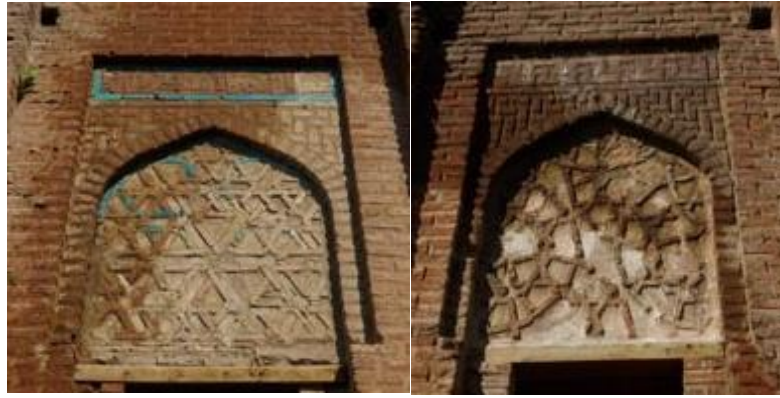
Şekil 2.1.-2.2. Tokat Niksar Kırkkızlar Türbesi (F: Cihat Taşkın).
