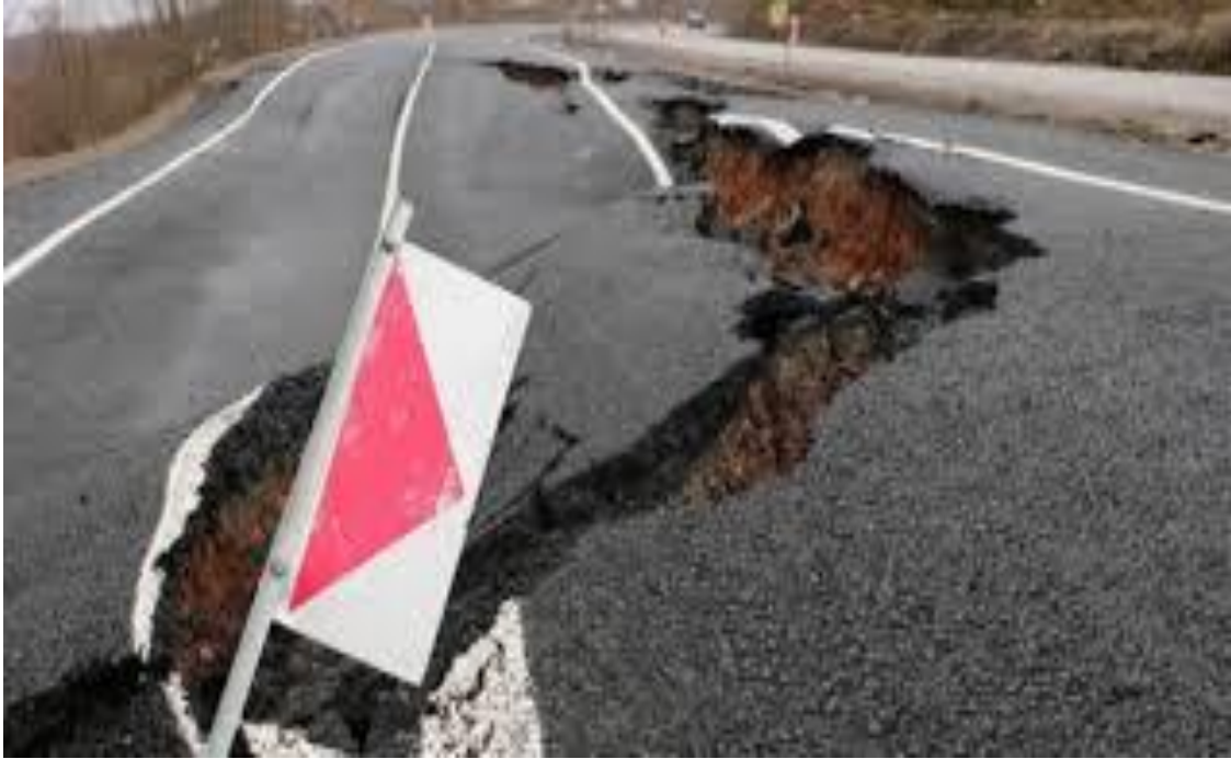
Şekil 2.10. Karayolundaki göçen zemin hasarı
