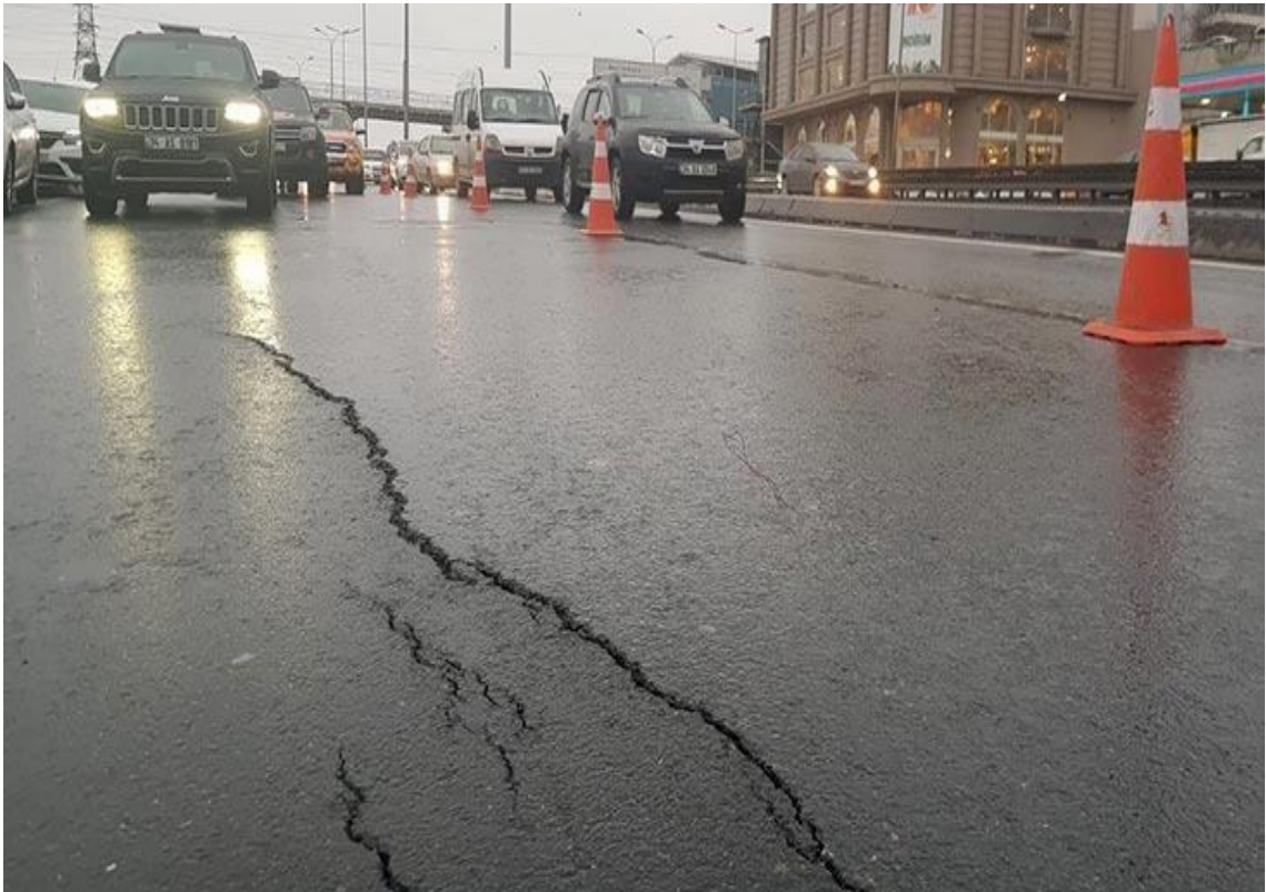
Şekil 2.3. Şişen zeminin karayolunda oluşturduğu çatlaklar
