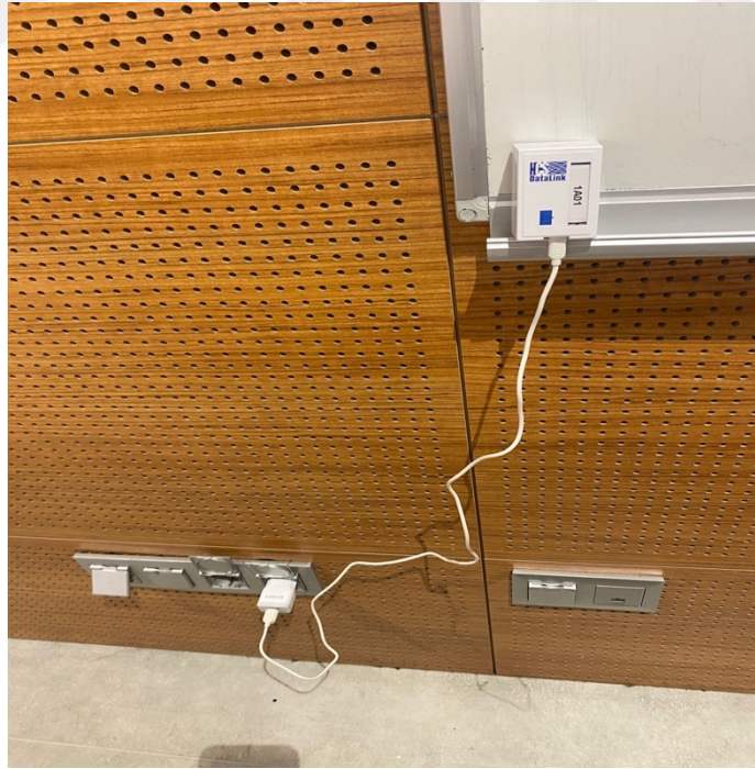
Şekil 4.1. ESP32 Modülünün Dersliklere Yerleşimi
