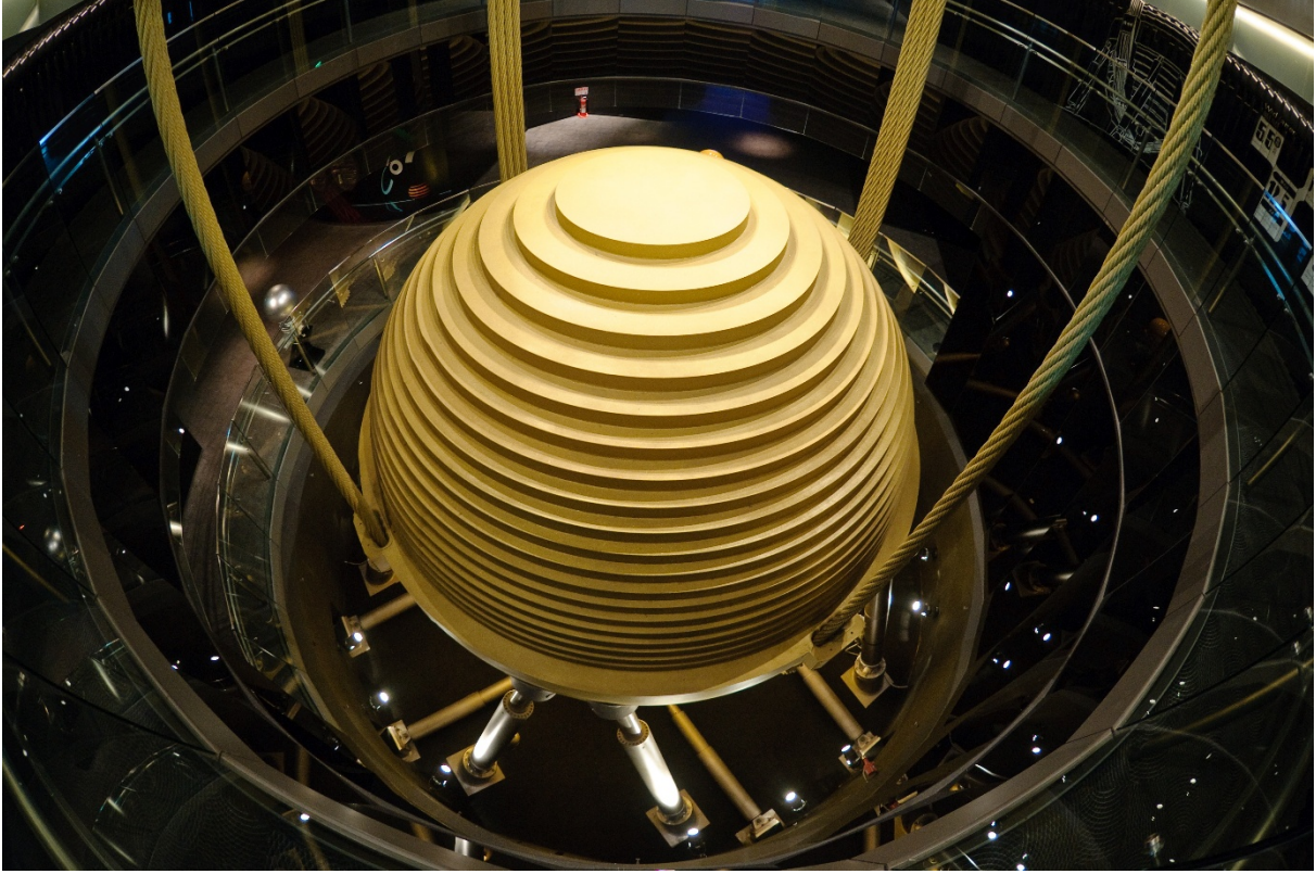
Resim 41-Taipei 101 binasının içerisinde bulunan damperin bir görüntüsü. Plessis, Armand du (2010, Haziran). Tuned mass damper on display in Taipei 101 . [Fotoğraf]. Wikimedia Commons.
