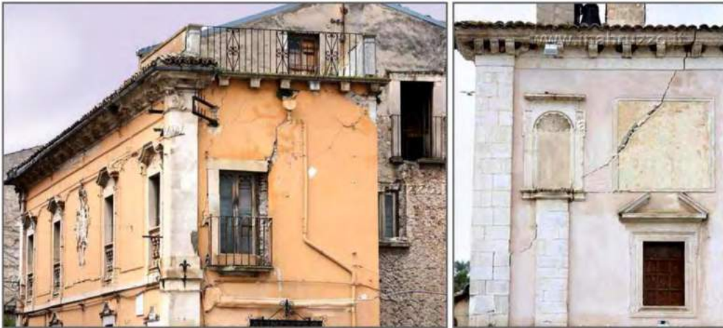
Şekil 3.22 Sismik etkide oluşan çatlamlar (Capozucca, 2008).
