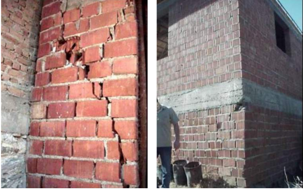
Şekil 3.19 Yığma yapıda oturmadan kaynaklı oluşan duvar hasarları (Çırak, 2011).
