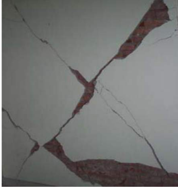
Şekil 3.21 Yığma duvarlarda oluşan kesme çatlağı (Doğangün, 2008).
