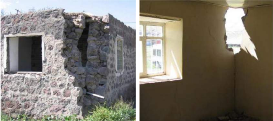
Şekil 3.24 Yığma yapılarda birleşim hasarları (Bayraktar, 2007).
