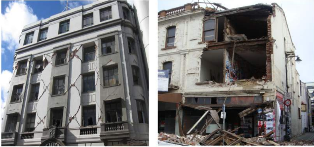
Şekil 3.16: Yığma yapılarda düzlem içi ve düzlem dışı oluşan hasarlar (Lin, 2013)
