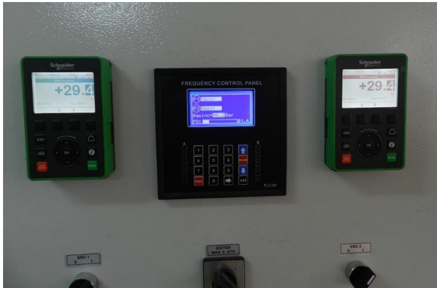
řekil 4.3. Pompaların devrini kontrol eden frekans konvertörlü pano
