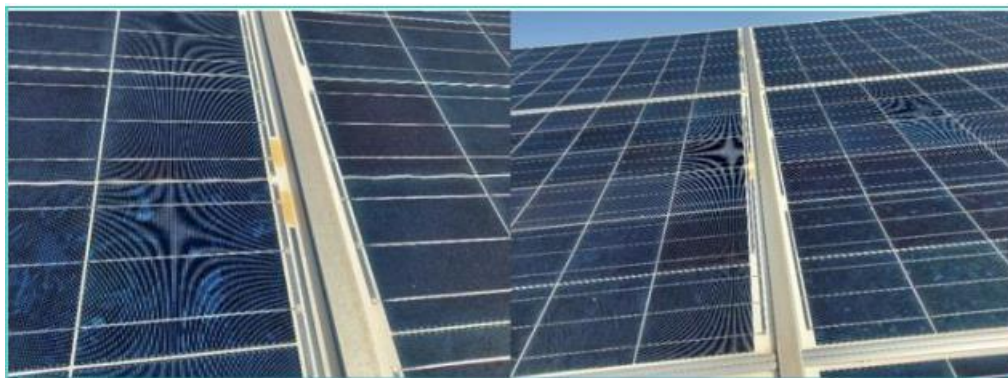
Şekil 3.31 Aşırı ısınmaya bağlı oluşan PV modül hasarları
