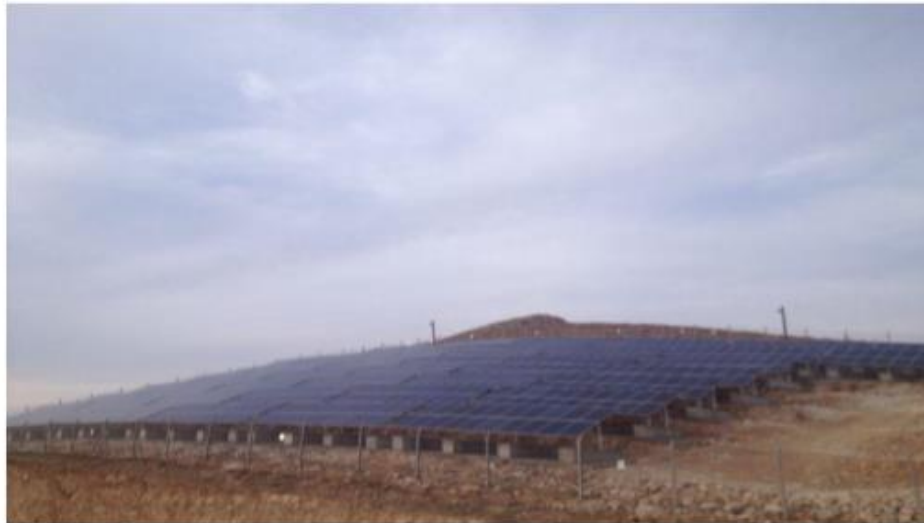
Şekil 3.1 250kW FV santral sahası
