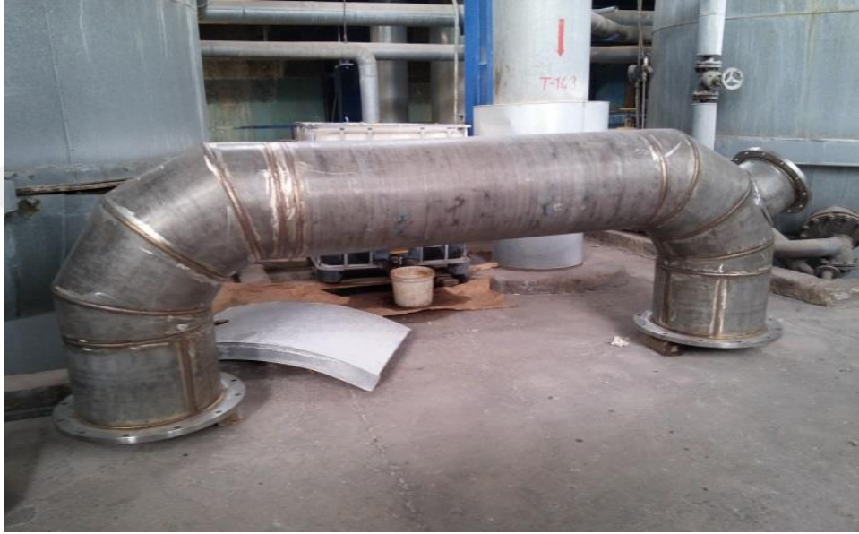
Şekil 4.13. Batarya aparat kuvvetli çözelti flaş tankı 812 çıkış boru hattı da A1sı 304 paslanmaz çelik malzeme
