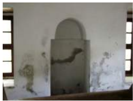
Gülşah Hatun Türbesi, Restorasyon Öncesi Mihrap Yüzeyi
