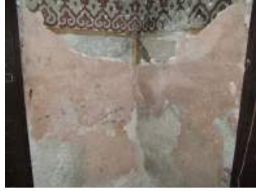
Mükrime Hatun Türbesi, Duvar Yüzeyi Bozulmalar 1
