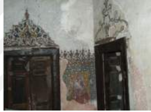
Mükrime Hatun Türbesi, Duvar Yüzeyi Bozulmalar 3
