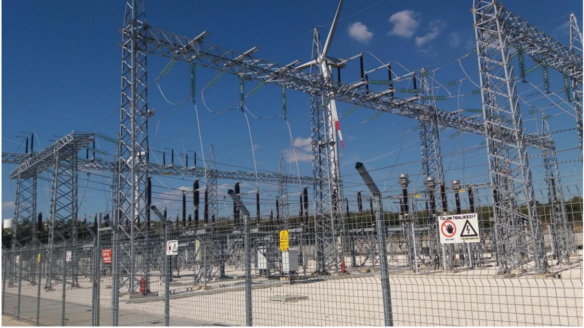
Şekil 4.3. Beşiktepe rüzgar enerji santralının şalt sahasından bir görünüm
