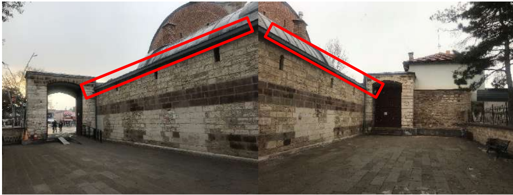
Şekil 6.7. Rüstem Paşa Kervansarayı restorasyon sonrası cephelerde bulunan kurşun kaplama drenaj (solda ve sağda)(Yazara ait fotoğraf arşivi, 2020-2022)
