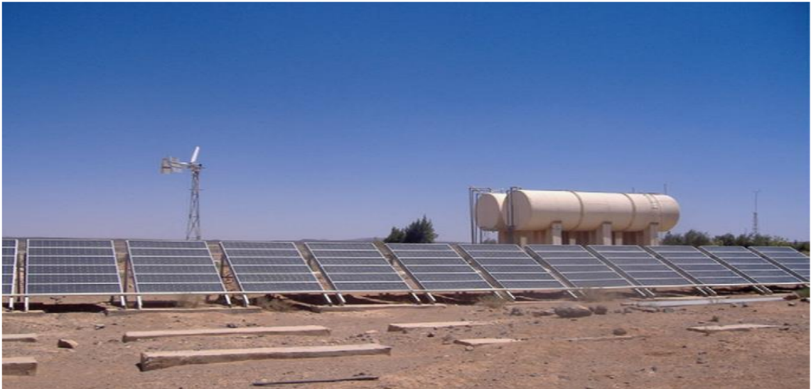
Şekil 2.5 Badia, Ürdün'deki 5,5 kW güneş enerjili su pompalama sistemi (Al-Smairan, 2012)
