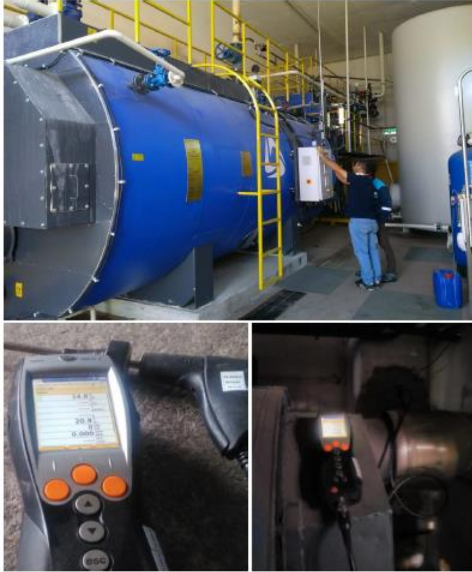
Şekil 4.1. Kazan Dairesinde Gerçekleştirilen Bir Baca Gazı Analizi
