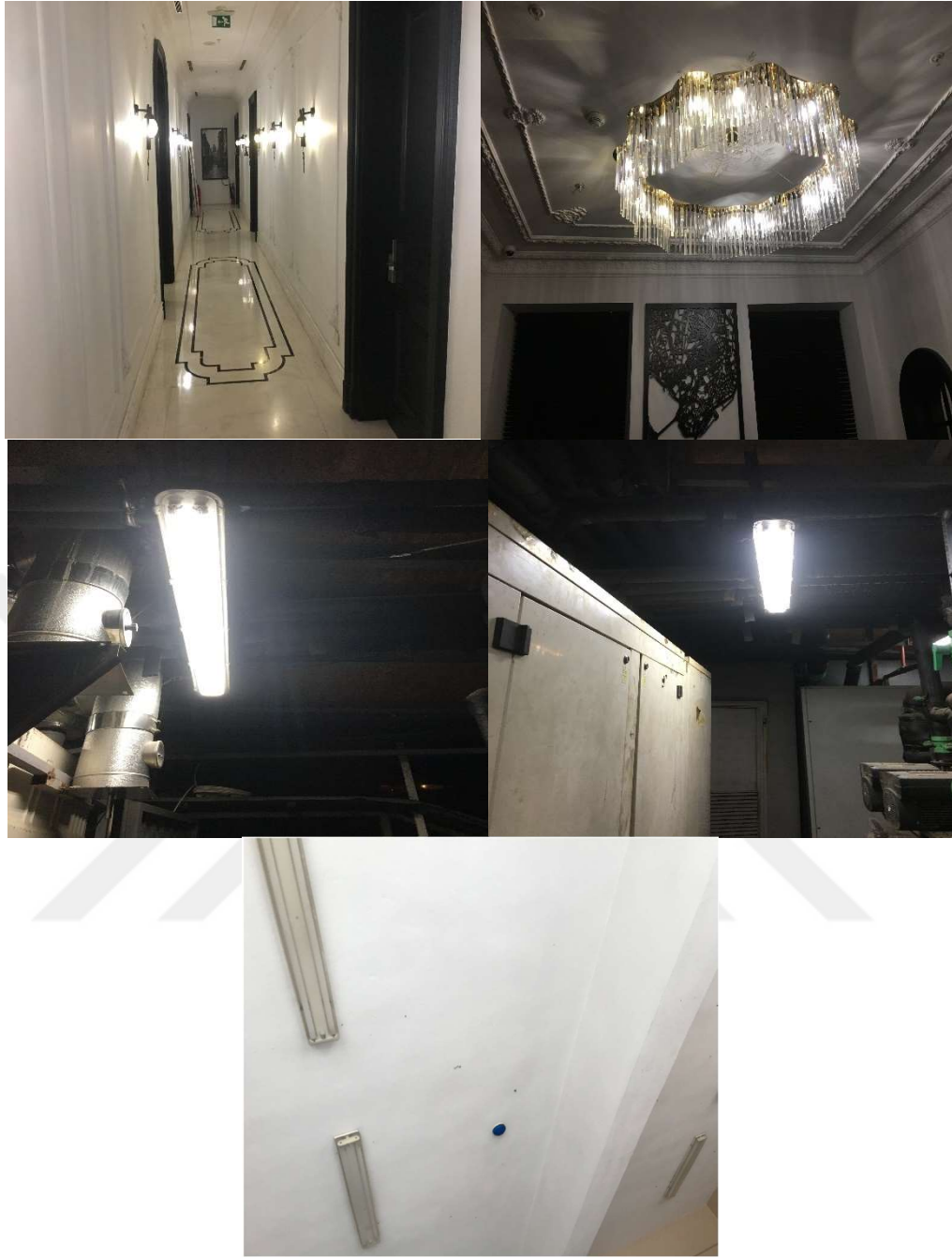
Şekil 4.16. Enerji Etüdü Yapılan Otel İşletmesindeki Verimsiz Armatür Tipleri
