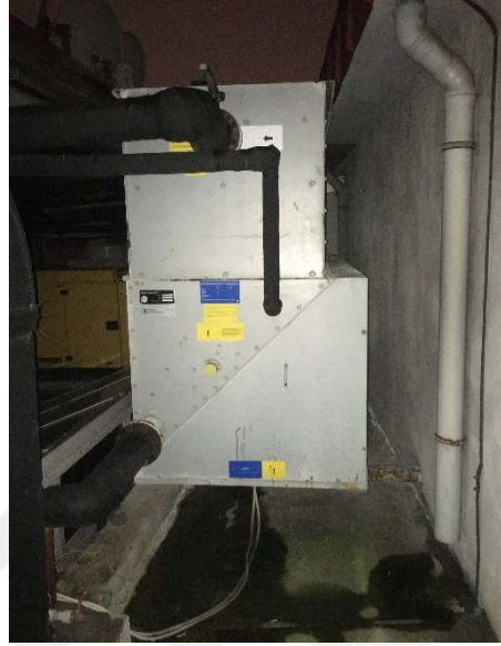
Şekil 4.4. Enerji Etüdü Yapılan Otel İşletmesi Chiller Ünitesi
