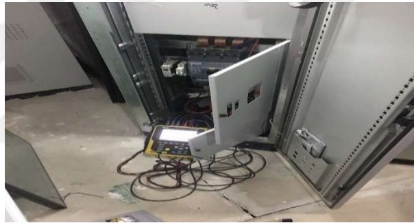
Şekil 4.6. Enerji Etüdü Yapılan Otel İşletmesi Ana Dağıtım (ADP) Panosu
