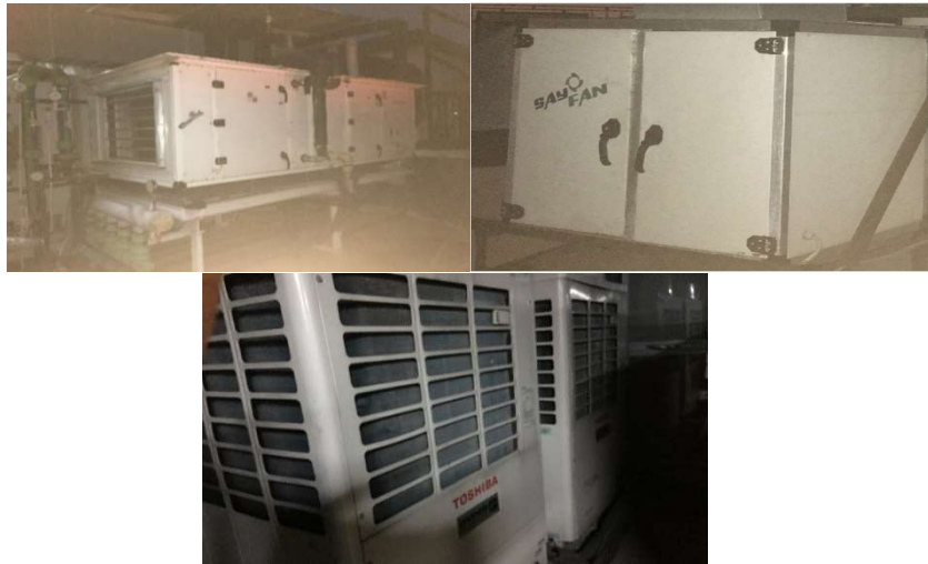
Şekil 4.3. Enerji Etüdü Yapılan Otel İşletmesi Havalandırma ve İklimlendirme Üniteleri
