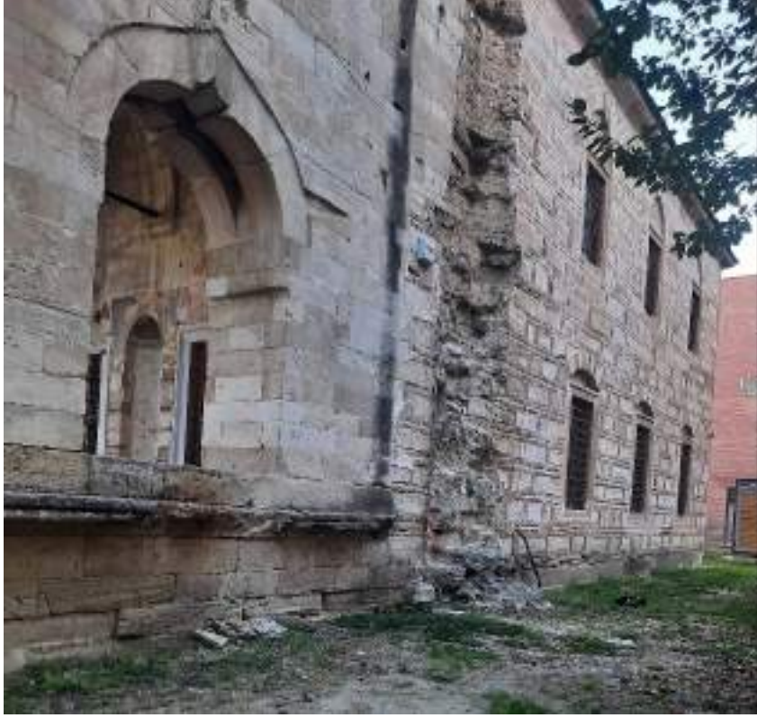
Fotoğraf 31. Zincirli Cami, yıkılan minarenin boşluğunun bulunduğu batı cephe (F: Ramazan Göğebakan, 2023)
