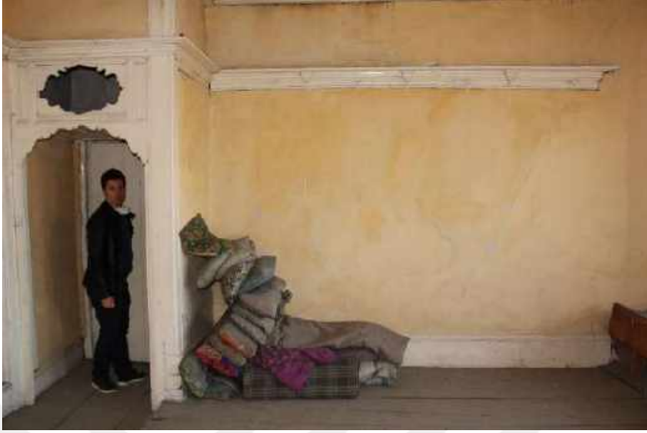
Resim 363: 177 Ada 2 Parseldeki Ev, Birinci Kat, Sağdaki Oda, Kuzey Duvarı
