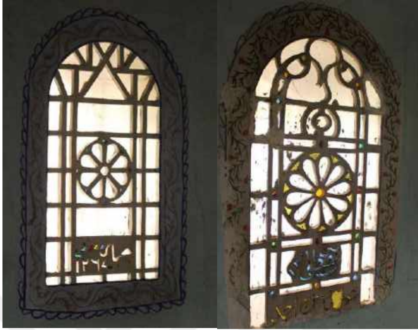
Resim 135: Çevlik Köyü Eski Mahalle Cami, Doğu Duvarında Yer Alan Revzenler
