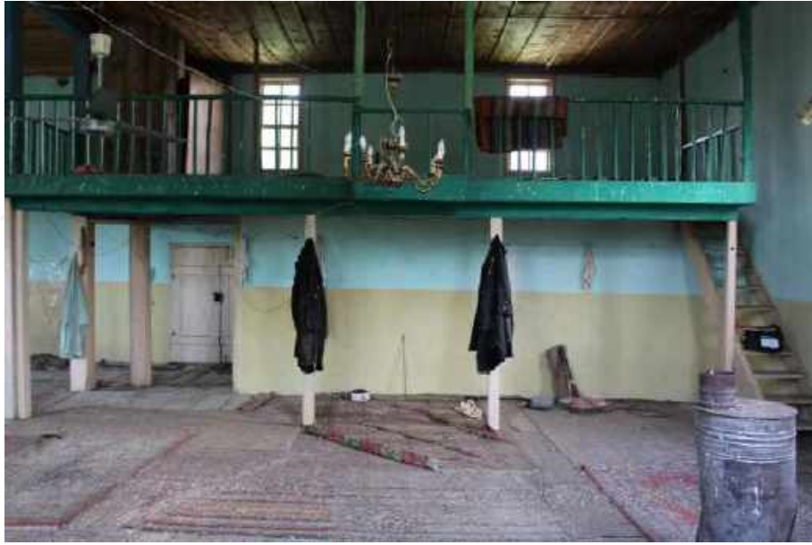
Resim 218: Çaykapı Köyü Camii, Harim, Kuzey Duvarı ve Mahfil
