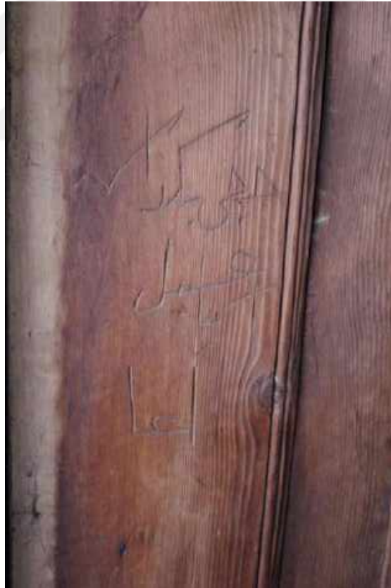
Resim 350: 177 Ada 2 Parseldeki Ev, Zemin Kat, Depo Kapı Kanadı
