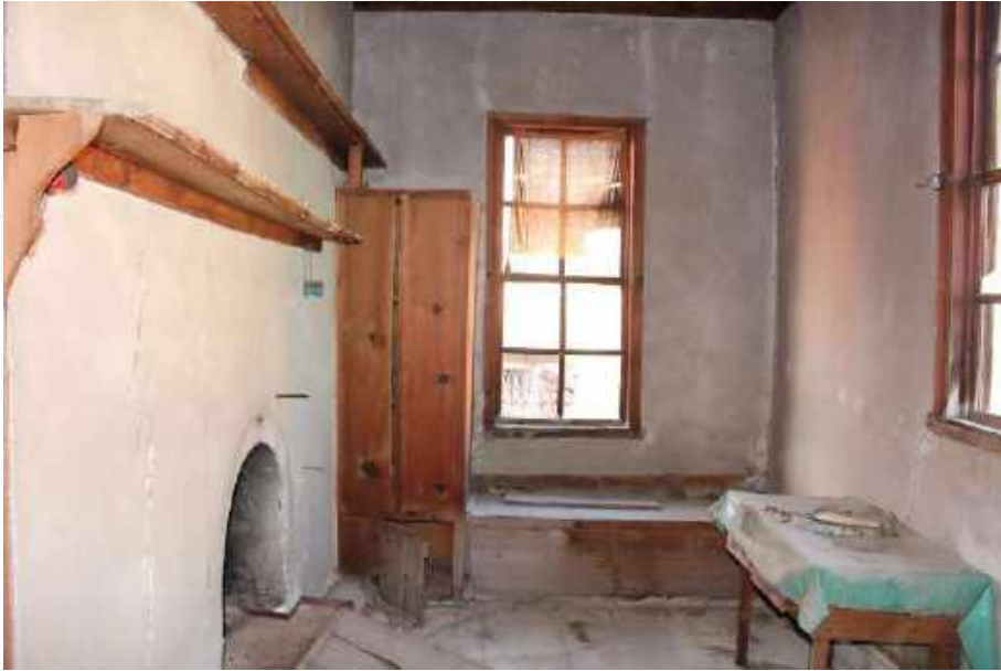
Resim 396: 141 Ada 1 Parseldeki Ev, İkinci Kat, Mutfak, Doğu ve Güney Duvarı
