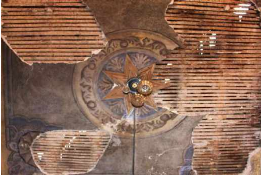
Resim 392: 141 Ada 1 Parseldeki Ev, İkinci Kat, Sağdaki Oda, Tavan
