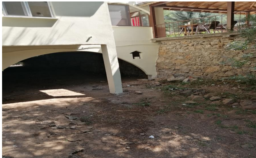
Şekil 4.22. Maden Köyü taşkın tesisi üzerine yapılan vatandaş müdahalesine ait görüntü
