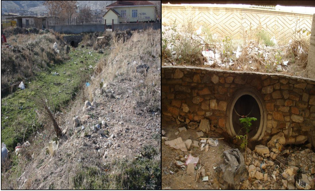
Şekil 4.29. Konya İli Yunak İlçesi Turgutlar Mahallesi taşkın koruma tesisi belirli bir kesimin okul bahçesi altından kapalı kesit olarak geçmesi ve bu durumun taşkın durumunda başta öğrenciler ve yerleşim yeri açısından risk oluşturmaya ait görüntü
