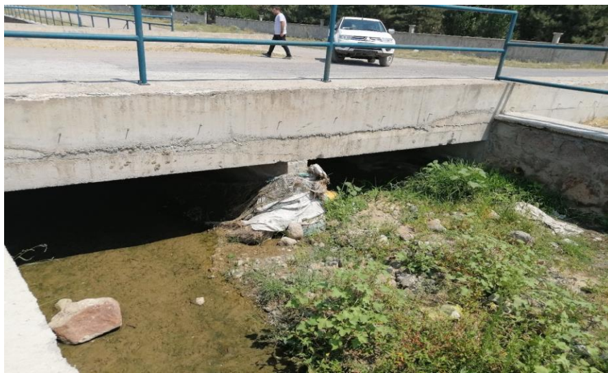
Şekil 4.13. Yetersiz kesitli sanat yapısına ait görüntü
