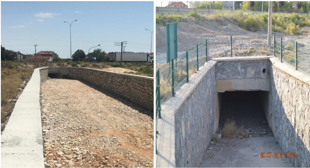
Şekil 4.7. Konya ili Cihanbeyli İlçesi İlçe Merkezi Taşkın Koruma Tesisi güzergâhı üzerinde bulunan Ankara-Konya karayolunu dik kesen menfez yapısının kesit yetersizliğini oluşturmasına ait görüntü
