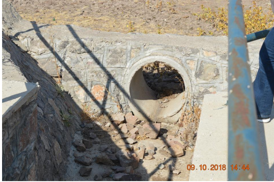
Şekil 4.35. Konya İli Kulu İlçesi Kırkpınar Mahallesi taşkın koruma tesisi memba kısmında tersip bendi amacı ile yapılan ancak havzadan gelen suyun tesise girişini engelleyen büze ait görüntü
