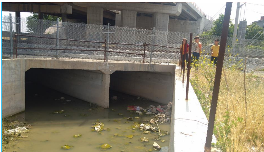
Şekil 4.8. Karayolları tarafından yapılan Hasanköy Üst Geçidi ile TCDD tarafından yapılan tren yolu inşaatları sırasında taşkın güzergâhı üzerinde yapılan uygun olmayan menfez imalatına ait görüntü
