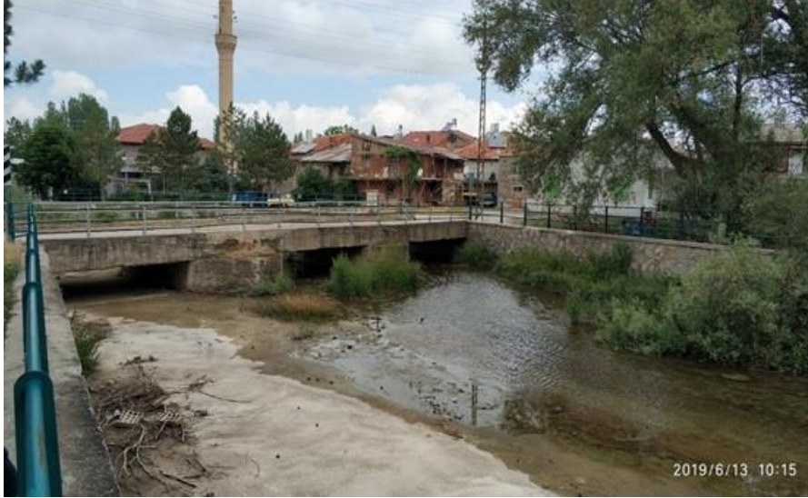
Şekil 4.33. Konya İli Beyşehir İlçesi Çukurağıl taşkın koruma tesisinde taşkına sebep olabilecek kadar kesiti yetersiz olan yol geçişine ait görüntü
