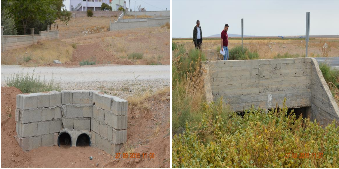
Şekil 4.34. Konya İli Kulu İlçesi Yeniceoba Mahallesi taşkın koruma tesisinde taşkına sebep olabilecek kadar kesiti daraltan büz müdahalesi ve menfezin rüsubat ile dolmasına ait görüntü
