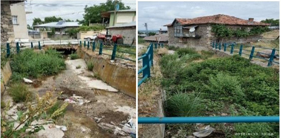
Şekil 4.32. Konya İli Beyşehir İlçesi Damlapınar taşkın koruma tesisinde kanal içerisinde taşkına sebep olabilecek kadar biriken rüsubat ve kesiti yetersiz olan menfeze ait görüntü
