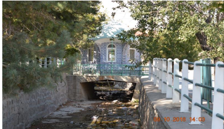
Şekil 4.17. Vatandaşlar tarafından taşkın tesisi üzerine yapılan müdahaleye ait görüntü
