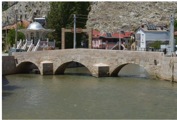
Şekil 4.11. Konya İli Bozkır İlçe Merkezi Taşkın Koruma Tesisi üzerinde yer alan tarihi Selçuklu Köprüsü'nün tesis üzerinde kesit yetersizliği oluşturmasına ait görüntü
