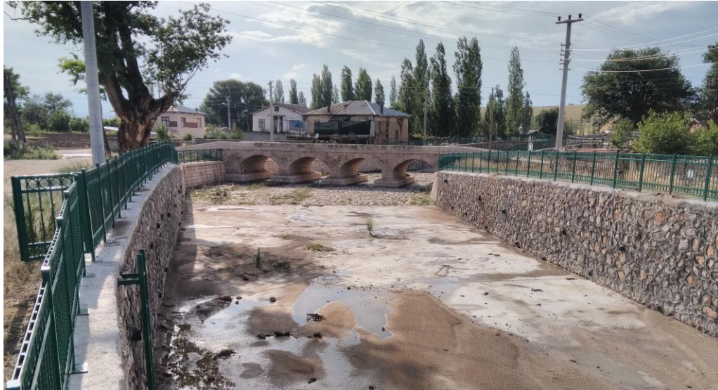
Şekil 4.12. Konya İli Akören İlçe Merkezinde Taşkın Koruma Tesisi üzerinde yer alan tarihi köprü tesisinde kesit yetersizliği oluşturmasına ait görüntü
