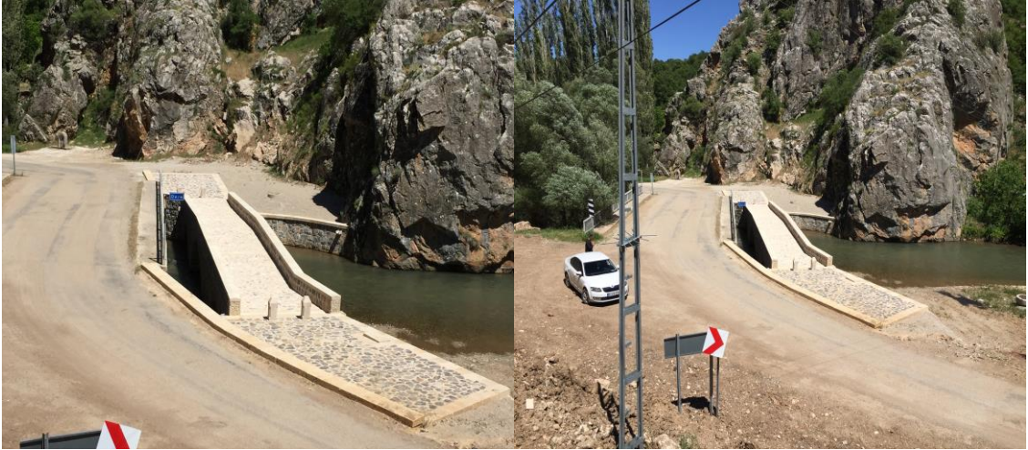
Şekil 4.6. Bozkır İlçesi Sorkun Taşkın Koruma Tesisi üzerindeki Yukarı Kemer Tarihi Köprüsü'nün mevcut betonarme köprü'nün memba kesiminde kesit yetersizliği oluşturmasına ait görüntü
