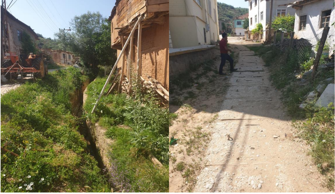
Şekil 4.37. Konya İli Ilgın İlçesi Belekler Mahallesi dere yatağının yerleşim yeri merkezinden dar kesitli olarak geçmesi ve başka bölgede kapalı kesit olarak geçmesi ve yetersiz kesit oluşturmasına ait görüntü
