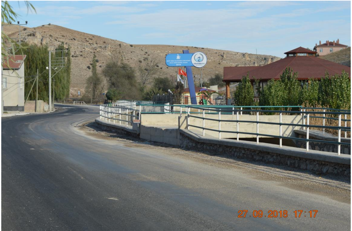
Şekil 4.36. Konya İli Cihanbeyli İlçesi İnsuyu Mahallesi taşkın koruma tesisi inşaatının projesine göre yapılmasından sonra yol kotunun düşük seviyede kalması ile taşkın üzerinden karşıya araç ile geçişin sağlanamamasına ait görüntü
