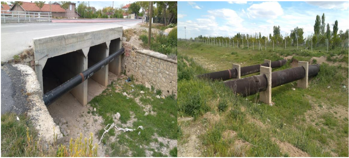
Şekil 4.9. KOSKİ tarafından DSİ'den uygun görüş alınmadan dere yatakları üzerinden sulama vb. boruların geçirilmesine ait görüntüler
