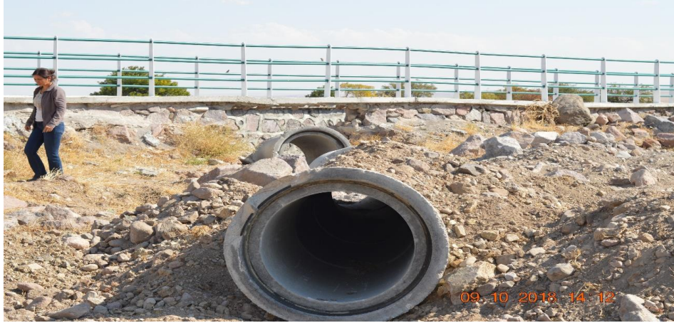
Şekil 4.18. Vatandaşlar tarafından taşkın tesisi üzerine yapılan müdahaleye ait görüntü
