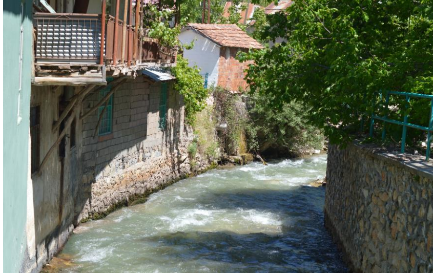
Şekil 4.16. Kamulaştırması yapılamayan ev duvarlarının taşkın tesisi duvarı görevini yapması can ve mal güvenliği açısından büyük risk teşkil etmesine ait görüntü
