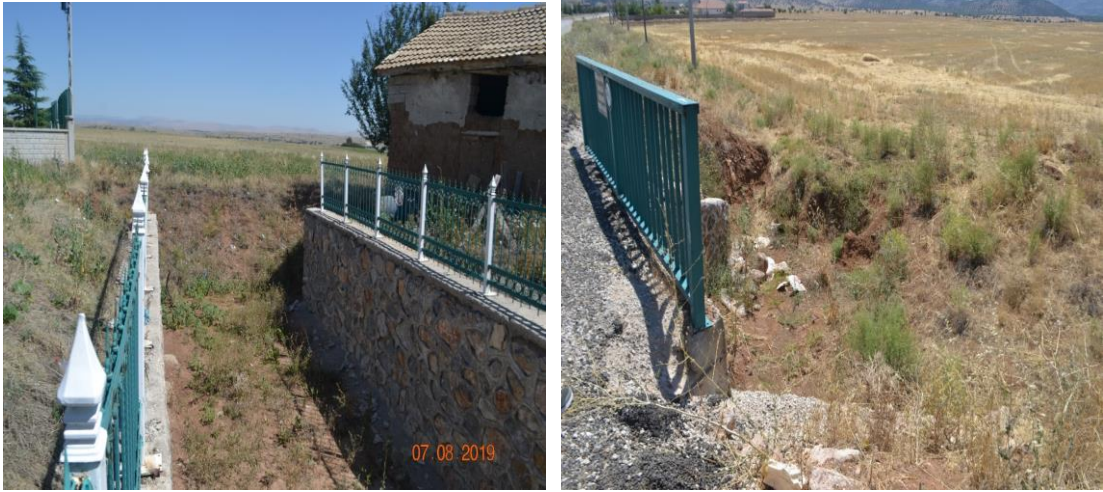
Şekil 4.15. Kamulaştırma sorunundan memba kısmı tamamlanamamış tesise ait görüntü
