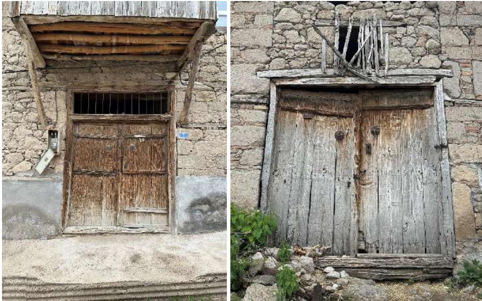
Şekil 4.55. Solda demir parmaklıklı ışıklı, sağda camsız pencereli ahır kapısı
