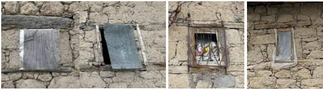
Şekil 4.52. Solda çinko saç levha kaplı, ortada ferforje demir kaplı, sağda naylon kaplı pencereler
