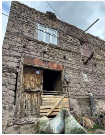
Şekil 4.29. Ahşap kirişlerin dış duvar yüzeyinden çıkması
