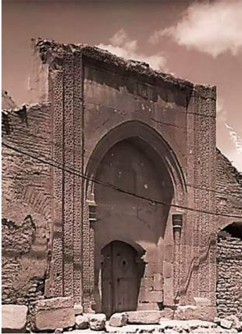
Şekil 2.12. Hânikâh Ön Cephesi Onarım Öncesi Hali (Yavaş 2015)
