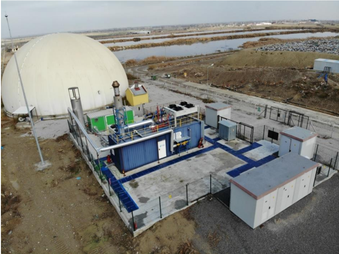
Şekil 2.18. Akşehir Metan Gazından Elektrik Enerjisi Üretim Tesisi (KBB, 2020)
