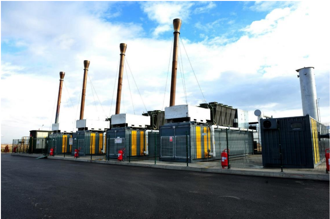
Şekil 2.17. Aslım Metan Gazından Elektrik Enerjisi Üretim Tesis (KBB, 2020)
