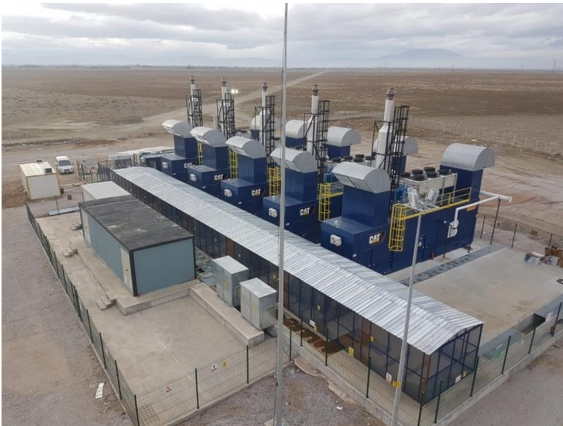
Şekil 2.19. Kaşınhanı Metan Gazından Elektrik Enerjisi Üretim Tesisi (KBB, 2020)
