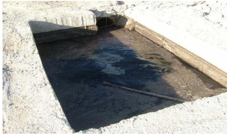
Şekil 2.20. Sızıntı Suyu Toplama Havuzu (Apaydın, 2007)
