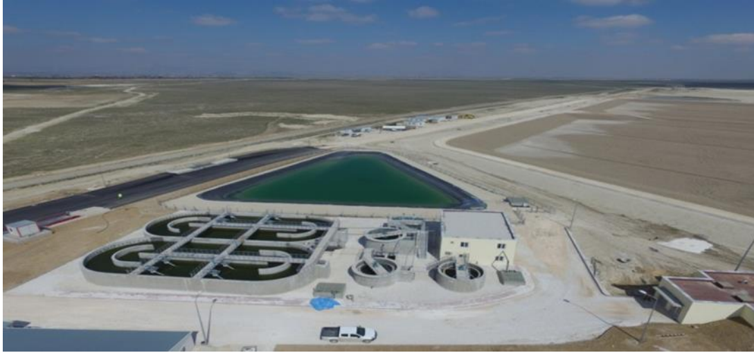
Şekil 2.22. Konya Katı Atık Sızıntı Suyu Arıtma Tesisi (Konya Büyükşehir Belediyesi)
