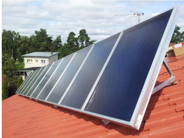
Şekil 1.1. Su ısıtma için kullanılan, genelde çatılara konulan düz yüzeyli termal sistem (PMR_Press_Release, 2019)
