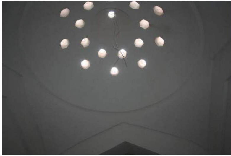
Fotoğraf.28. Karapınar Valide Sultan Hamamı sıcaklık kubbesine ait altıgen kesitli fil gözleri. *Fotoğraf yazar tarafından 2019 yılında çekilmiştir.
