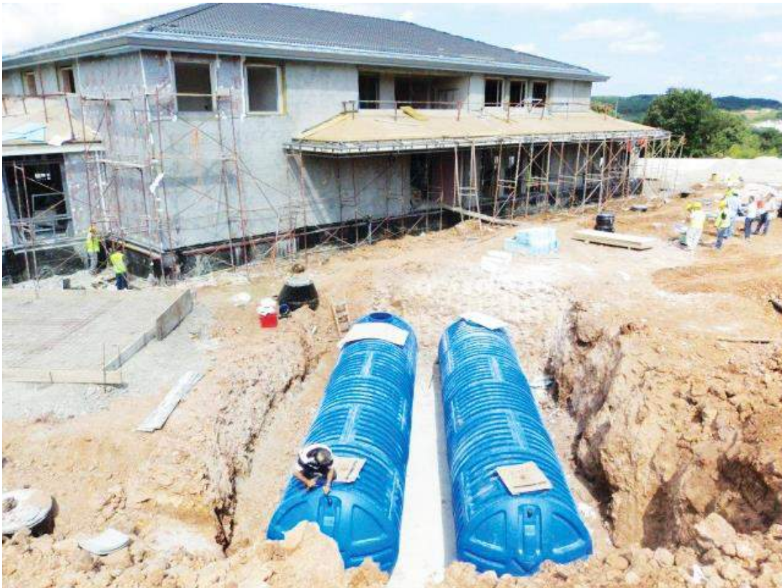
Fotoğraf.66. Yağmur suyu tanklarının yapıdaki konumu ve uygulaması (URL – 59).
