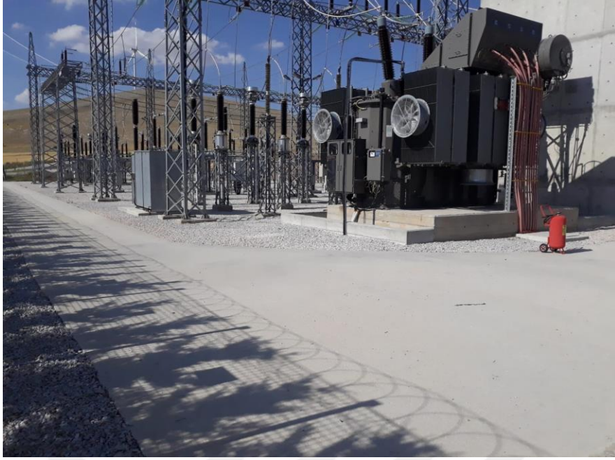
Şekil 6.17.Ardıçlı RES indirici trafo merkezi
