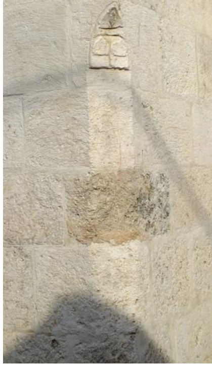
Fotoğraf 15: Kantara Cami Minaresi Kaide Güneybatı Köşe Pahu
