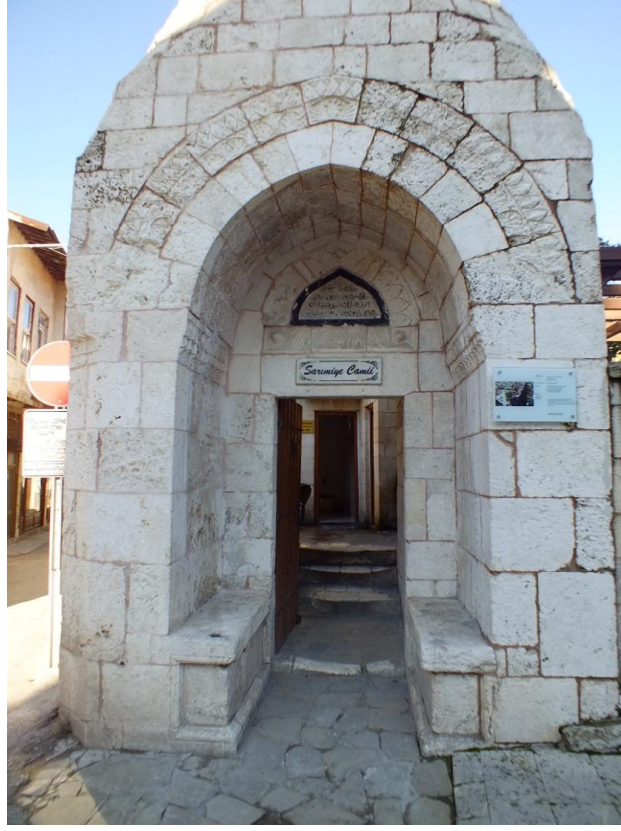
Fotoğraf 69: Sarımiye Cami Minaresi Kaide Batı Cephe
