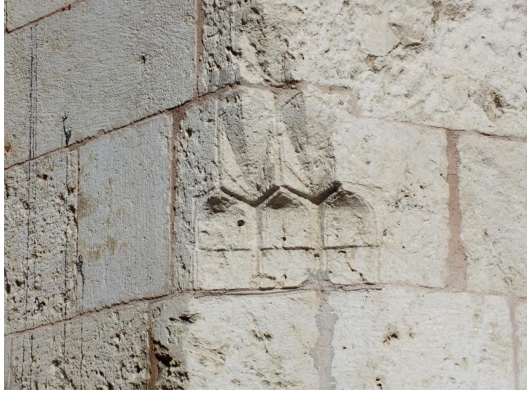
Fotoğraf 71 : Sarımiye Cami Minaresi Kaide Kuzeybatı Cephe Köşe Pahu
