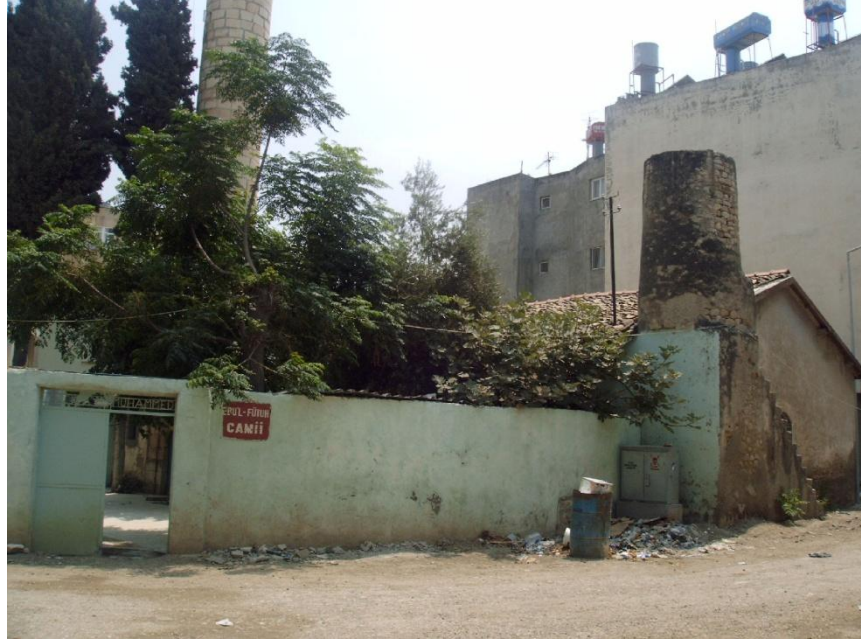
Fotoğraf 269: Altınözü Fadikli Cami Minaresi Onarım Öncesi Durumu (HVBM Arşivi'nden)
