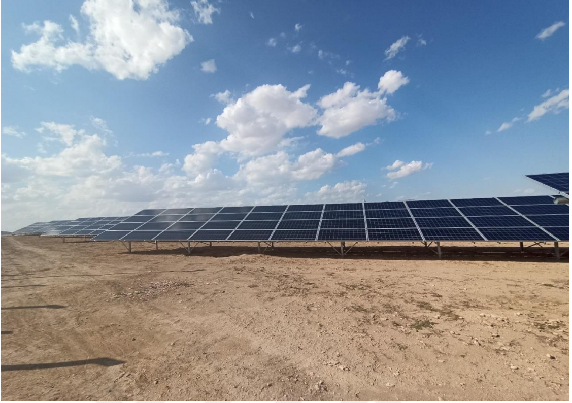
Şekil 4.13. Santralde bulunan FV modüllerin görünümü.
